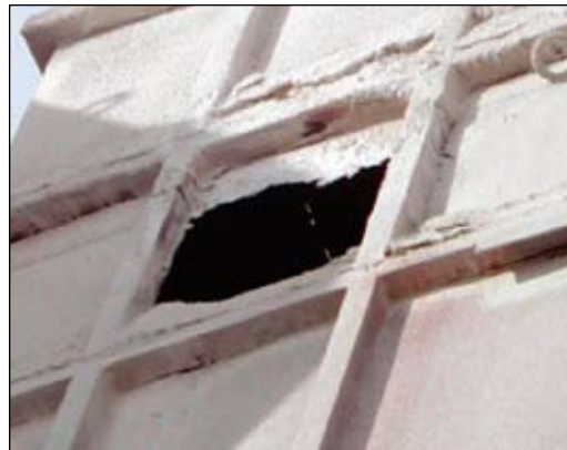
Figura 3. Detalle de un ducto de aire de un horno de clinker, mostrando la pérdida de un panel metálico debido a ataque por corrosión.
