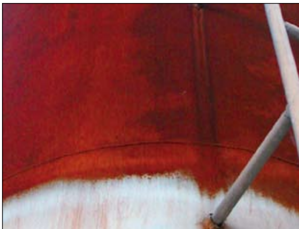
Figura 2. Detalle de la base de la chimenea de la planta de clinker, mostrando zonas con diferente estado superficial en la misma estructura.
