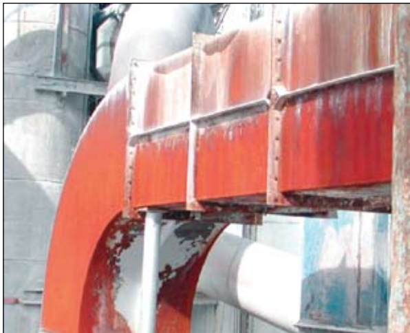
Figura 1. Corrosión generalizada en un ducto de aire de la planta de clinker.
