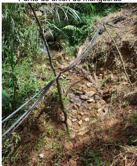
Mangueras utilizadas para la distribución
