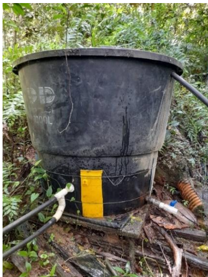
b. Tanque de almacenamiento 1 (Captación nacimiento)
