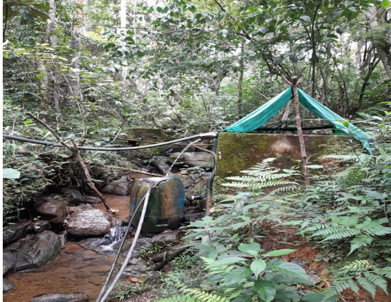
Tanque de almacenamiento 1 y captación del sobrante
