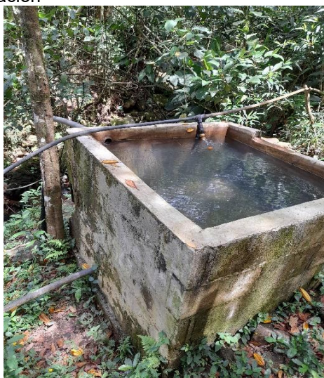
Tanque de almacenamiento para 3 viviendas
