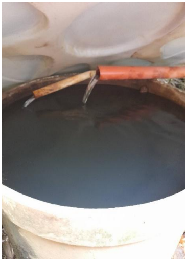
Tanque de almacenamiento 1
