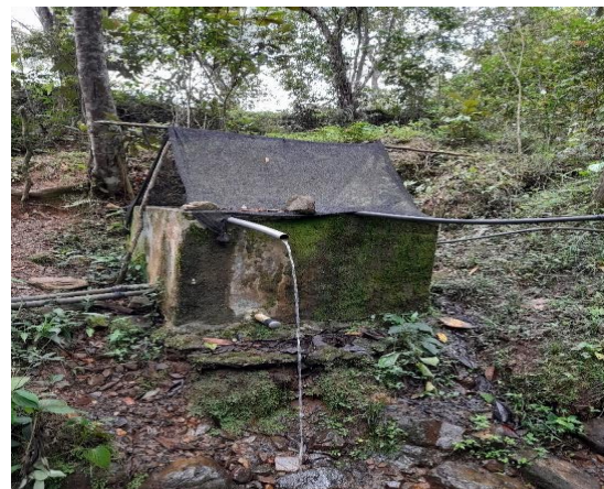
Tanque de almacenamiento 2
