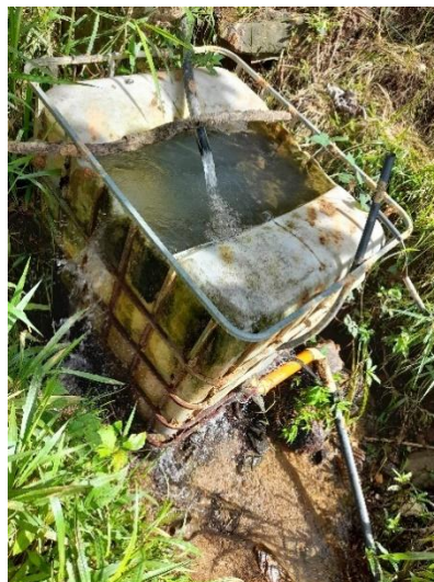
c. Tanque de almacenamiento 2 (Captación parte media)
