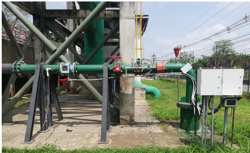
Ilustración 2. Fuente subterránea, Pozo profundo Apartadó (PPAP)
