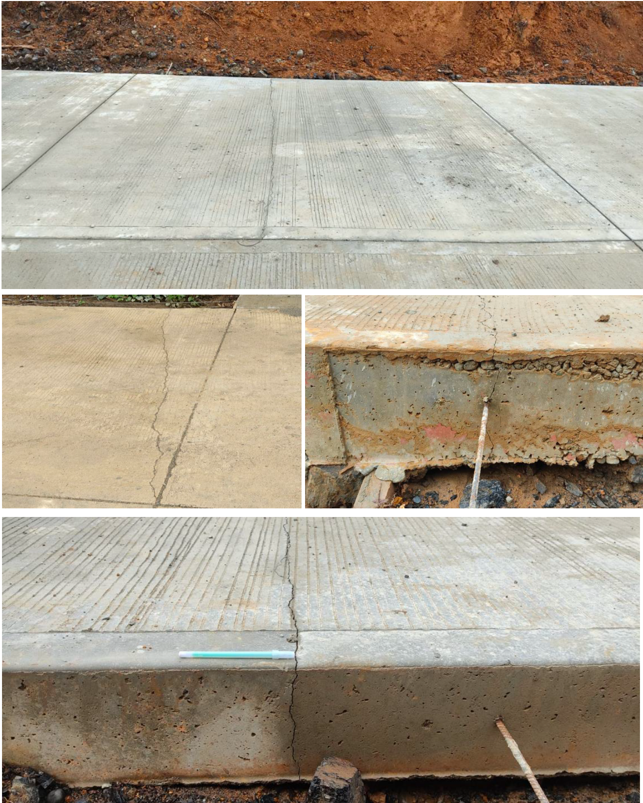
Fig. 19. Fracturas en distintas placas de la obra de pavimentación.
