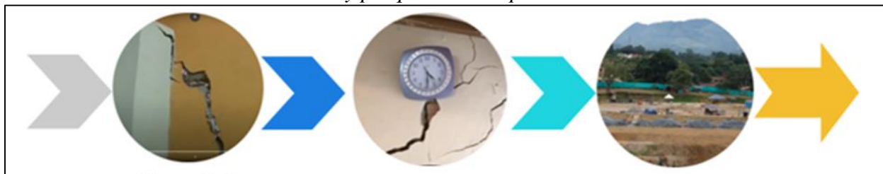
Grietas de las viviendas ocasionadas y parqueadero Depobuces
