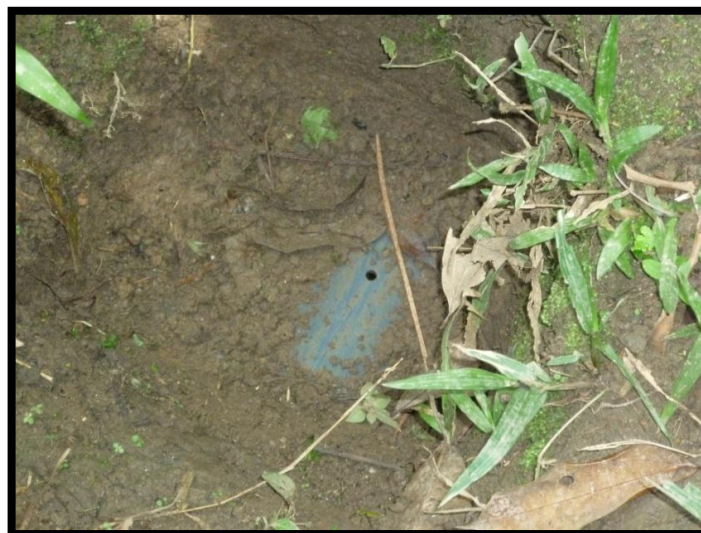
Foto 32. Ventosa de la línea de conducción Fuente: Investigadoras
