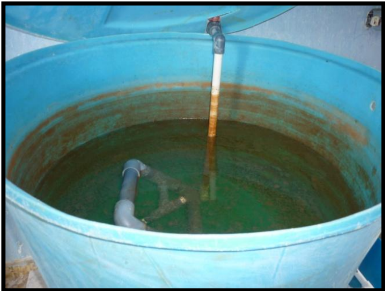
Foto 18. Tanque dosificador de cloro Fuente: Investigadoras
