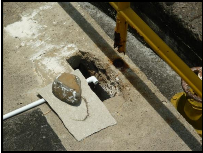
Foto 17. Dosificación de cloro Fuente: Investigadoras
