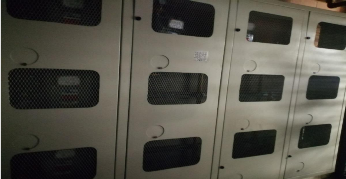
Figura 4 Gabinetes de medidores de agua potable
