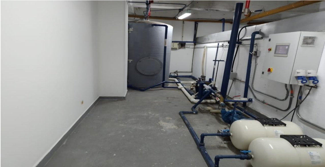
Figura 3 Sistema de almacenamiento y bombeo de agua potable
