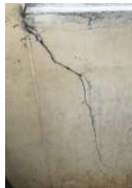
Ilustración 21. Grieta con aproximadamente 3 mm de espesor
