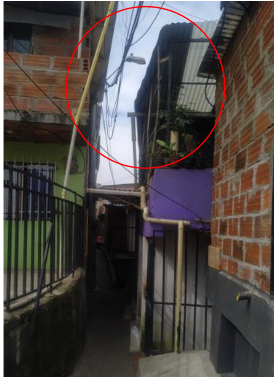
Fig. 11. Evidencia de luminaria que interfiere con urbanismo.
