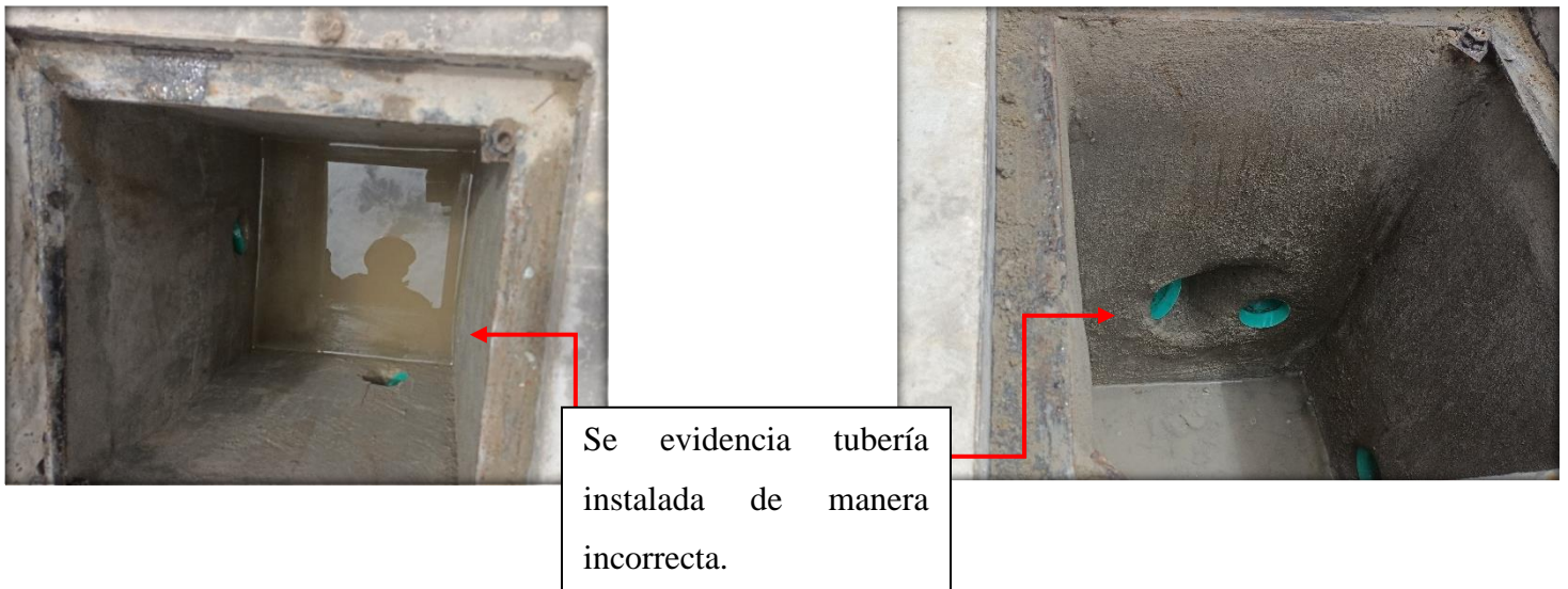
Fig. 36. Evidencia de tubería inadecuada en caja de AP.
