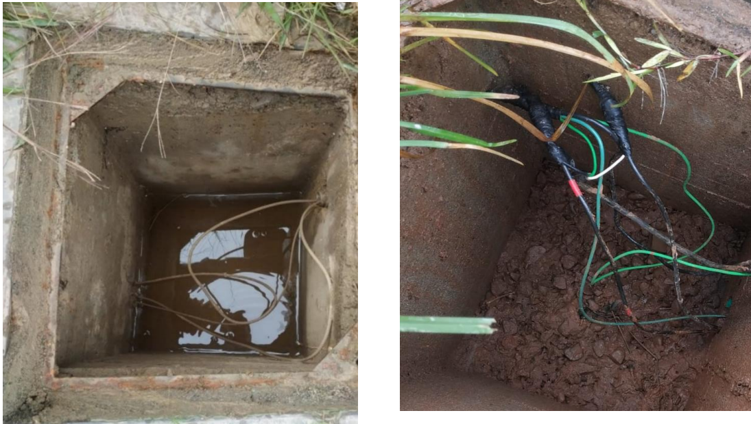
Fig. 25. Evidencia incumplimiento de la norma para cajas de AP.
