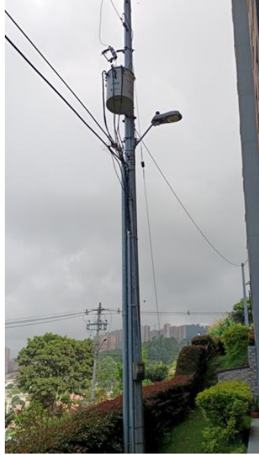
Fig. 22. Evidencia de diferentes postes en visita de campo.
