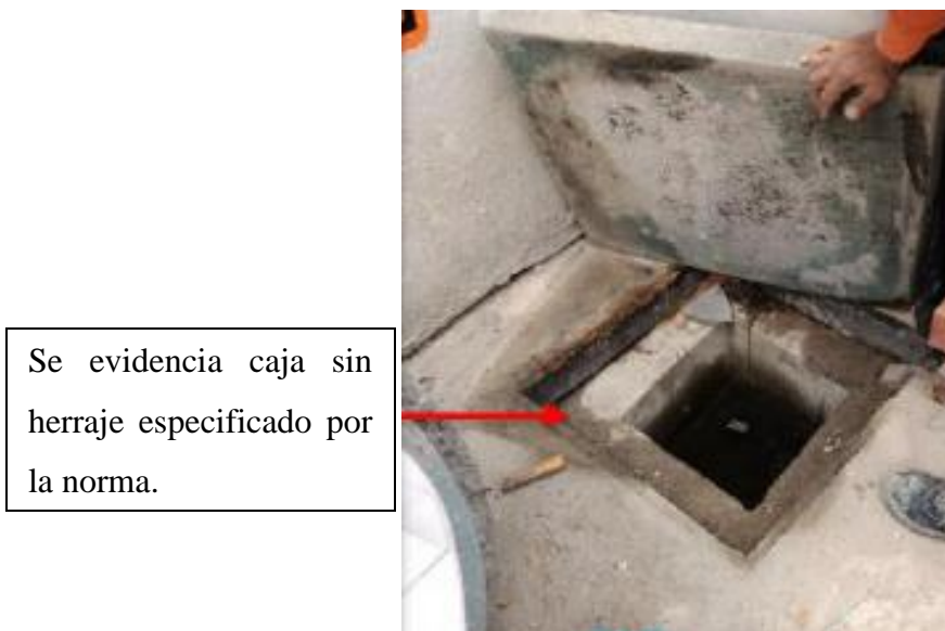
Fig. 35. Evidencia de caja sin herraje encontrada en inspección de obra.
