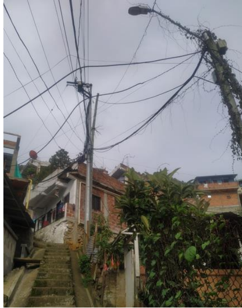
Fig. 13. Evidencia de requerimiento de nuevo brazo.
