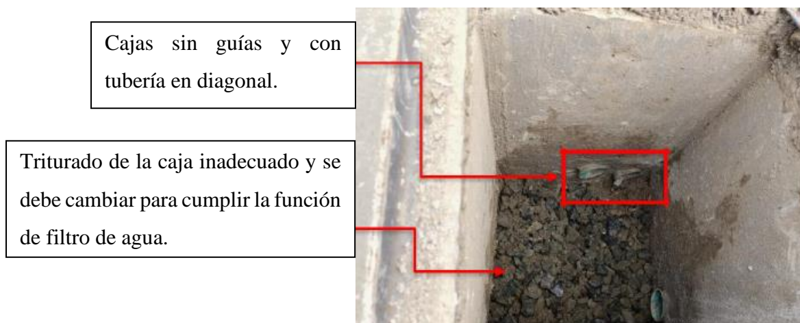
Fig. 33. Evidencia de tubería y triturado inadecuado en caja de AP en obra.
