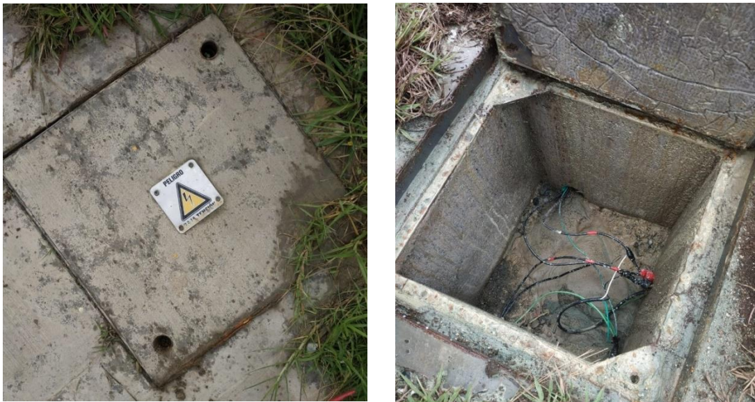
Fig. 24. Evidencia de cajas obstruidas, sin filtro y sin tornillería/tapones.
