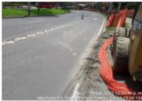
Seguimiento A bordillos de Andén en zona de Entrada y Salida de Vehículos
