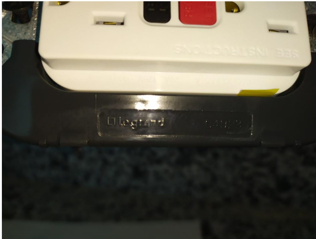
Fig. 32. Tomacorrientes GFCI marca legrand.
