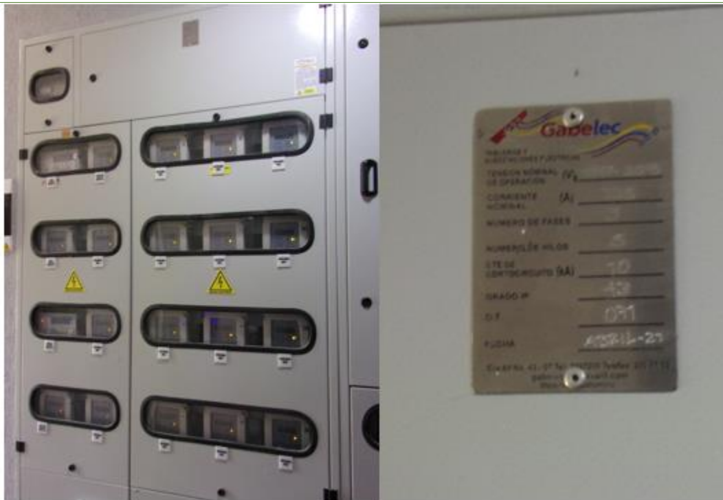
Fig. 41. Gabinete para medidores marca Gabelec.
