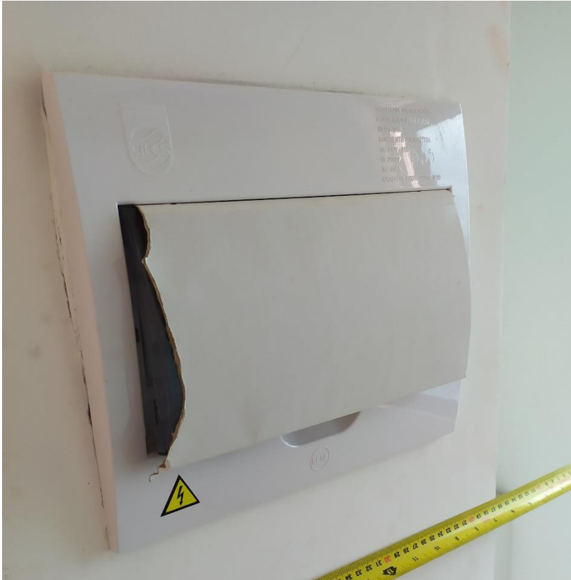
Fig. 29. Tablero de distribución marca Ciles.
