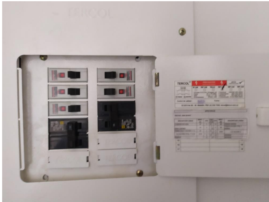
Fig. 30. Tablero de distribución marca Tercol.
