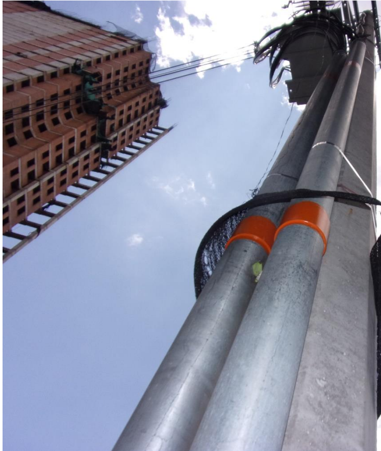
Fig. 64. Tubería metálica marca Fuji.
