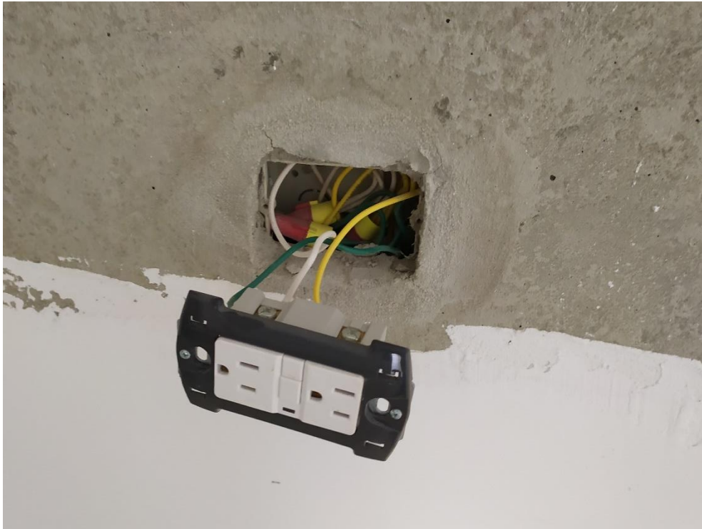
Fig. 34. Tomacorrientes GFCI marca Schneider.
