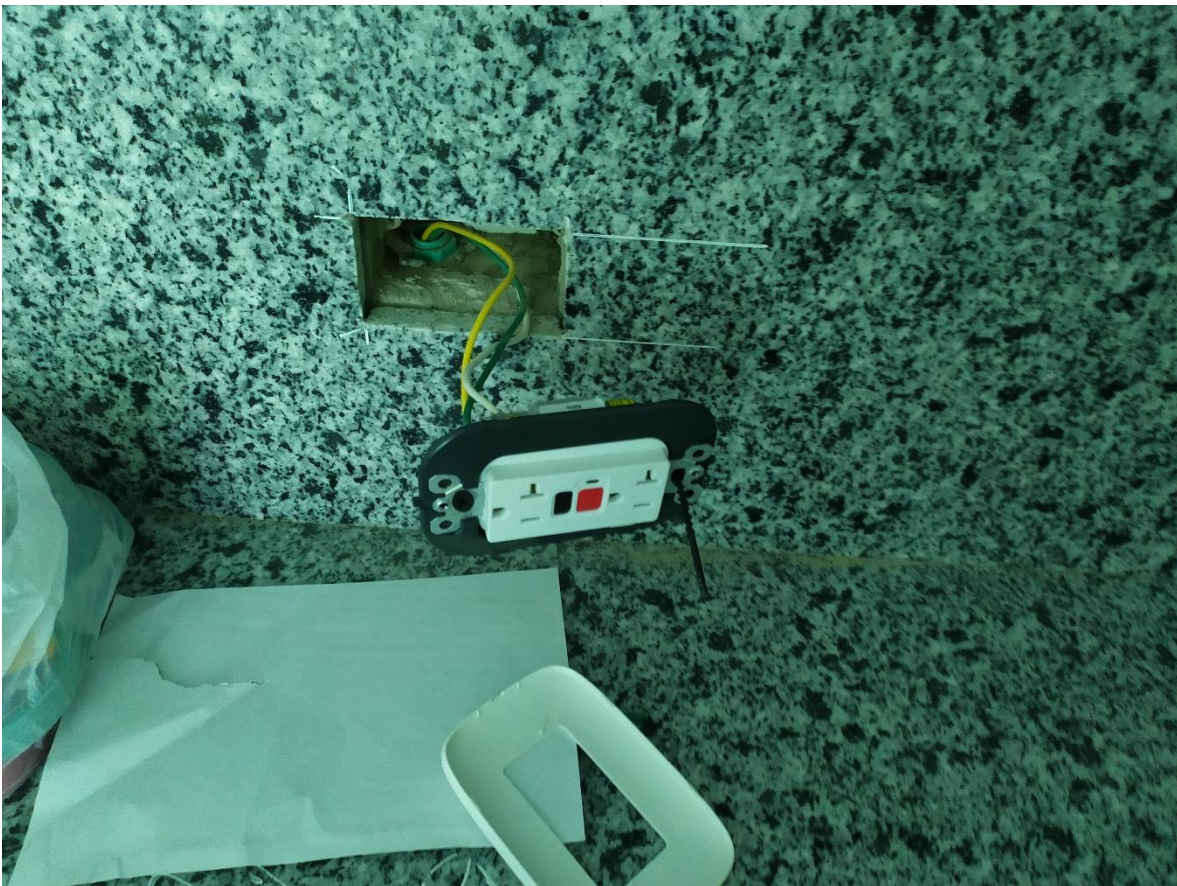
Fig. 31. Tomacorrientes GFCI marca legrand.
