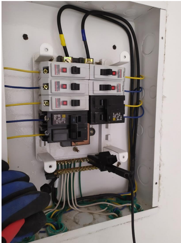
Fig. 20. Conductores eléctricos marca centelsa y cinta aislante eléctrica marca 3M.
