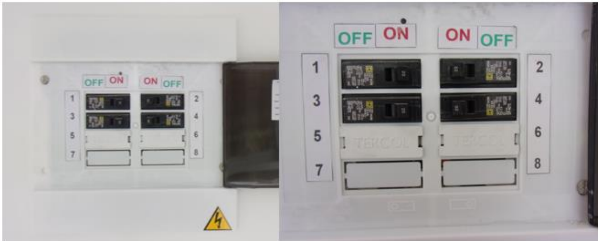
Fig. 44. Tableros eléctricos marca Tercol e interruptores automáticos marca Square D.
