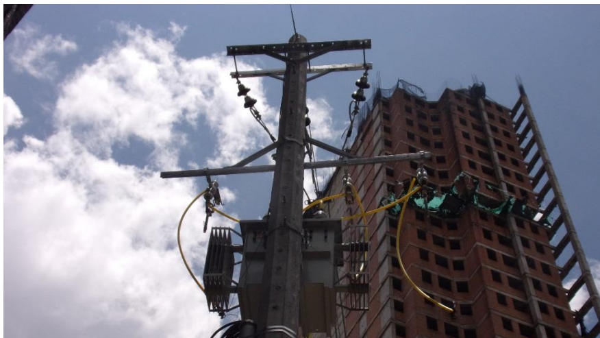
Fig. 61. Cruceas de uso en estructuras de apoyos de redes eléctricas marca Fundiherrajes y herrajes para redes de distribución marca Impuche.
