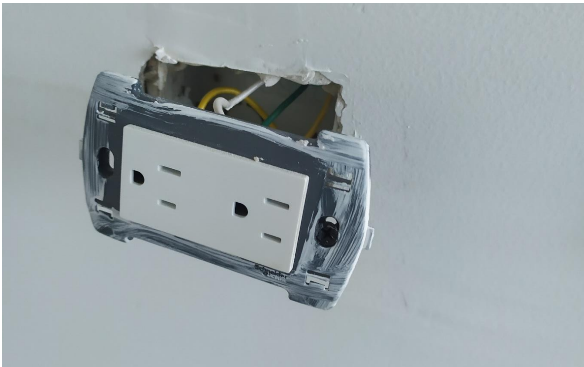
Fig. 33. Tomacorrientes marca Schneider.
