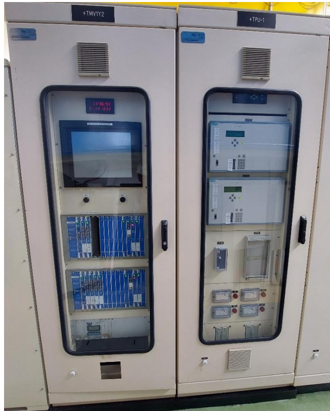
Figura 2. Tablero de protección principal de una unidad de generación.
