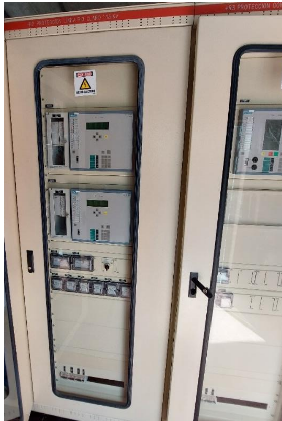
Figura 4. Tablero de protección principal de las líneas de transmisión.
