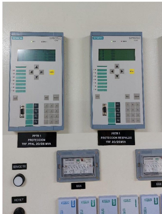
Figura 3. Tablero de protección principal de los transformadores de la Central.
