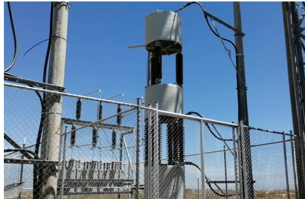
Fig. 26. Banco de compensación de reactivos 34,5 kV.
