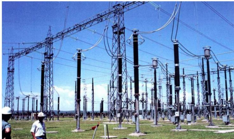
Figura 1. Subestación aislada en aire. Fuente: Universidad Pontificia Comillas.
