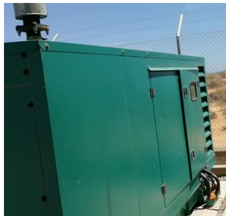
Figura 31. Grupo electrógeno vista general.
