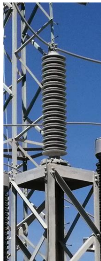
Figura 22. Descargador de sobretensiones o DPS.
