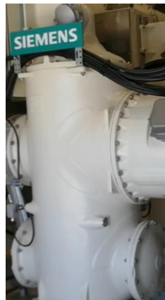
Figura 15. Interruptor de potencia en la bahía.
