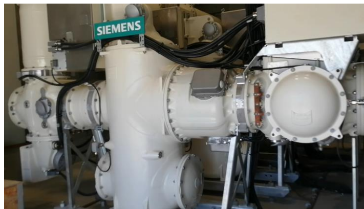
Figura. 3. Módulo aislado en GIS de la subestación HIS. Fuente: Autor.
