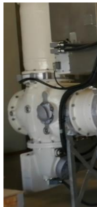
Figura 17. Seccionador de línea de tres posiciones (Tierra, abierto, cerrado).
