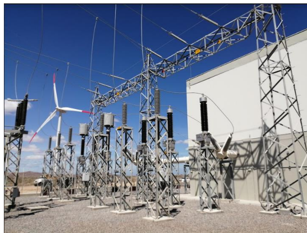
Figura. 4. Equipos aislados en aire de la subestación HIS. Fuente: Autor
