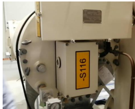
Figura 11. Módulo del transformador de tensión.
