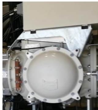
Figura 9. Modulo del Seccionador de tres posiciones (Tierra, abierto, cerrado).
