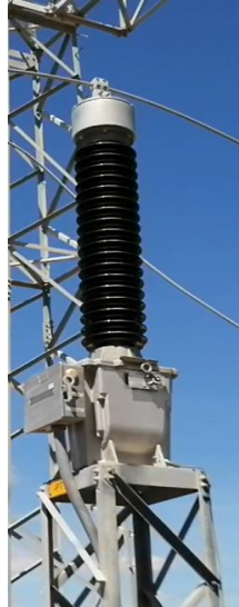
Figura 20. Transformador de tensión tipo capacitivo.
