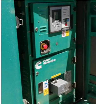
Figura 32. Grupo electrógeno, panel de control local.
