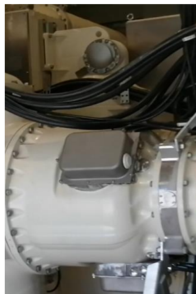
Figura 13. Módulo del transformador de corriente.
