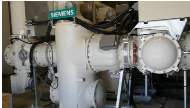
Figura 8. Modulo GIS de la barra de 110 kV.
