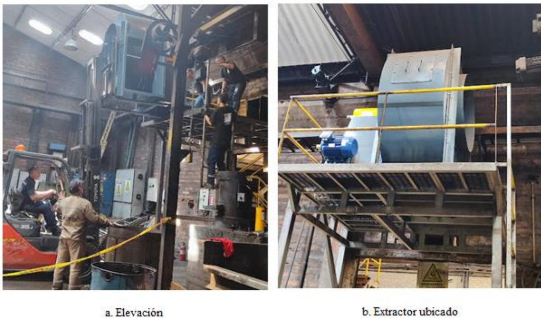
Figura 16. Ubicación del equipo extractor.
