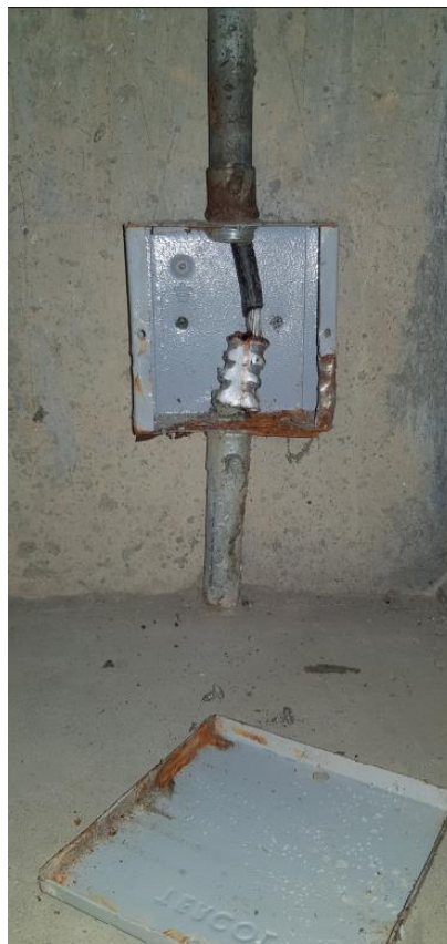
Figura 16. Caja de bajante sin evidencia de conexión
