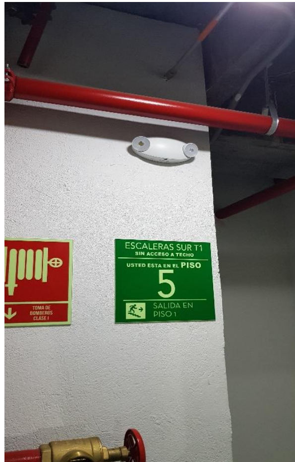
Figura 1. Iluminación de Emergencia
