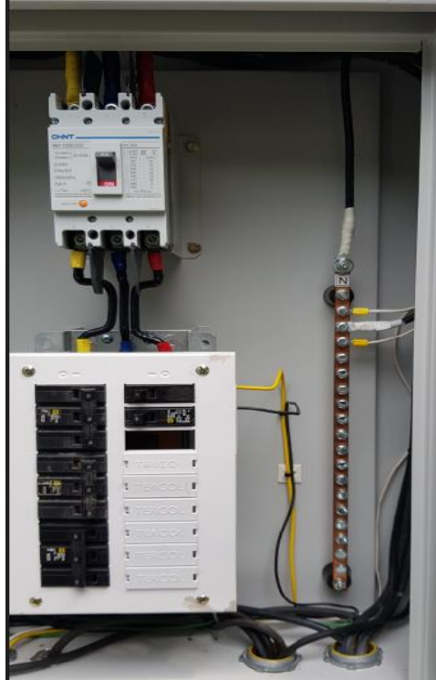
Figura 11. Tablero petar sin DPS
