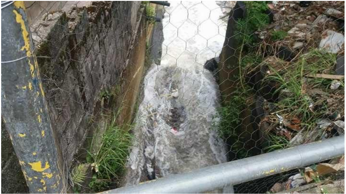
Figura 40. Registro fotográfico de factores que inciden en la presencia de olores en zonas de estudio, Comunas 8, 9 y 10, Medellín, 2017.
