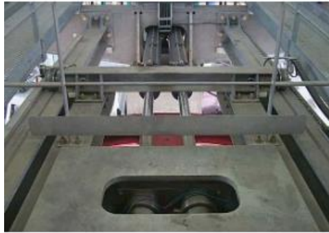
Figura 24. Cilindros tensores de Línea K del metro de Medellín.
