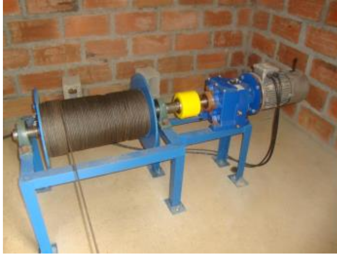
Figura 6. Unidad motriz de sistema de transporte bicable de una finca cafetera [23].
