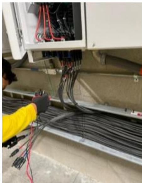
Fig. 4. Chequeo de variables eléctricas
