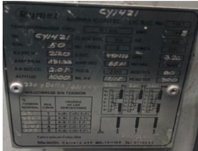
Fig. 8. Datos de placa transformador de 50 kVA
