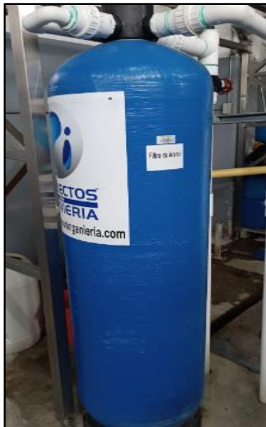
Figura 13 Filtro multimedia de arena y antracita
