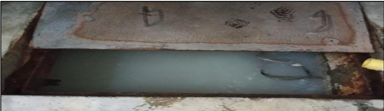
Figura 8 Tanque 3 homogeneizador de agua cruda residual
