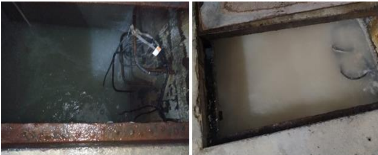
Figura 6 Tanques de recepción de agua cruda residual
