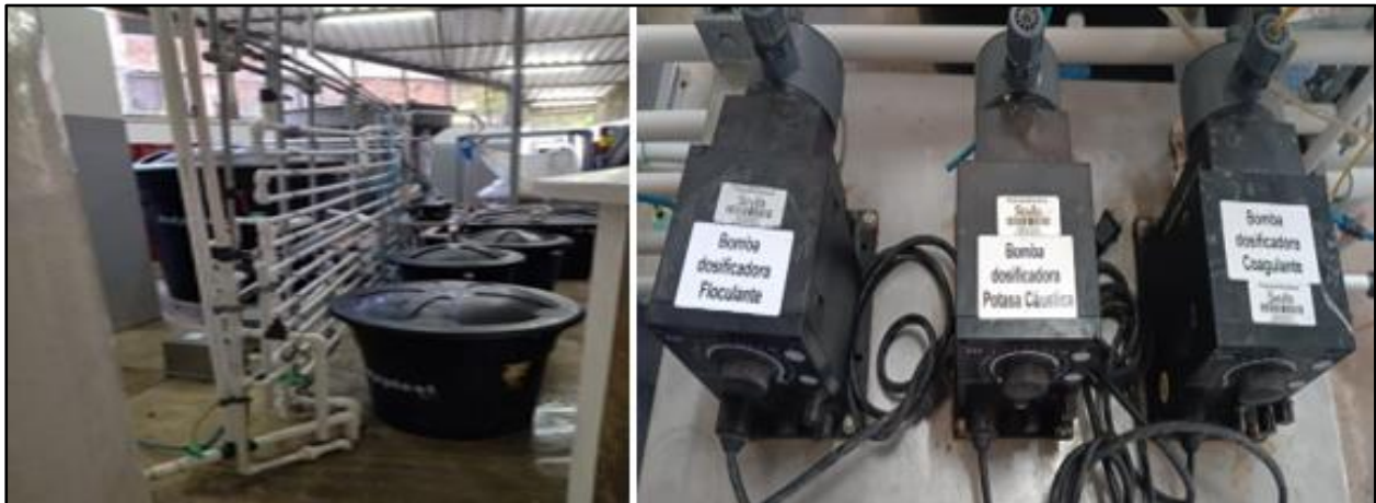
Figura 10 Mezclador estático – Serpentín y bombas dosificadoras
