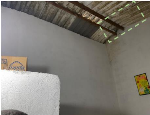
Imagen 2. La cubierta se encuentra en estado de deterioro.
