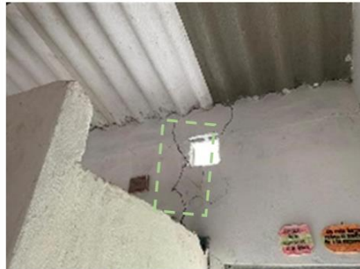
Imagen 2. Los muros presentan grietas considerables.
