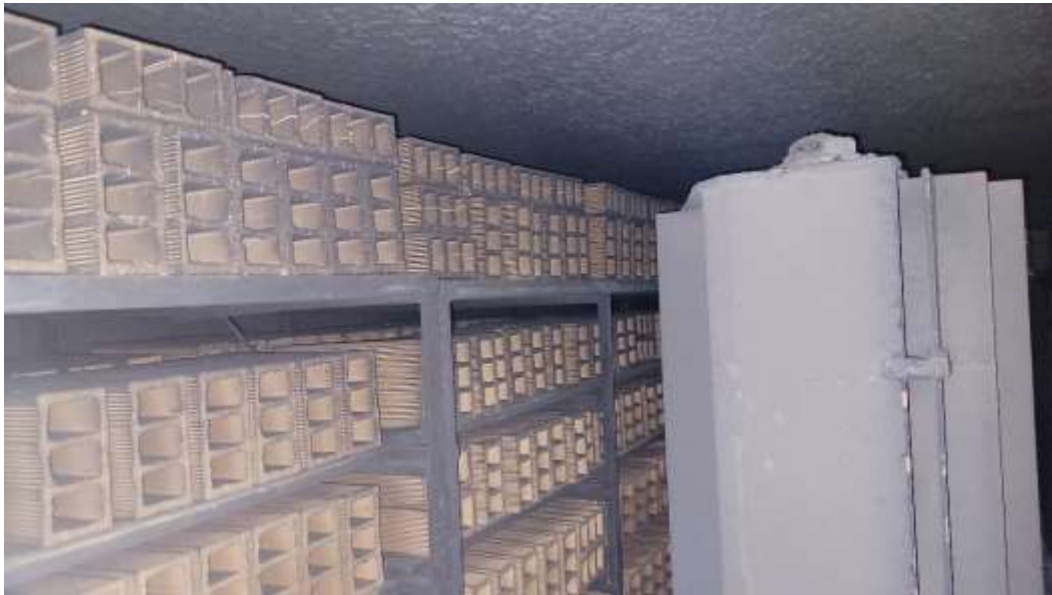
Figura 17. Rotura en los ladrillos ubicados en la parte superior de la estantería.
