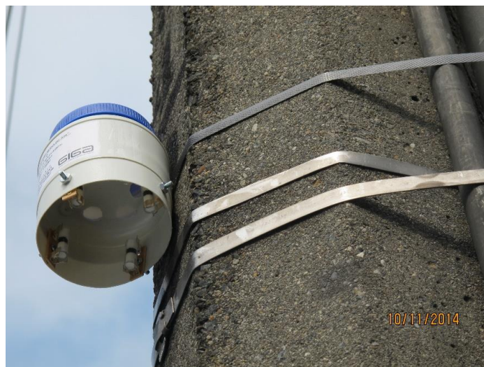
Figura 47. Captadores instalados en un poste de energía
