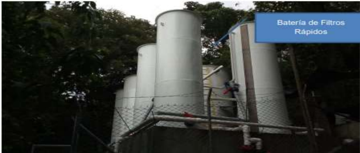
Ilustración 11: Batería filtros delgados
