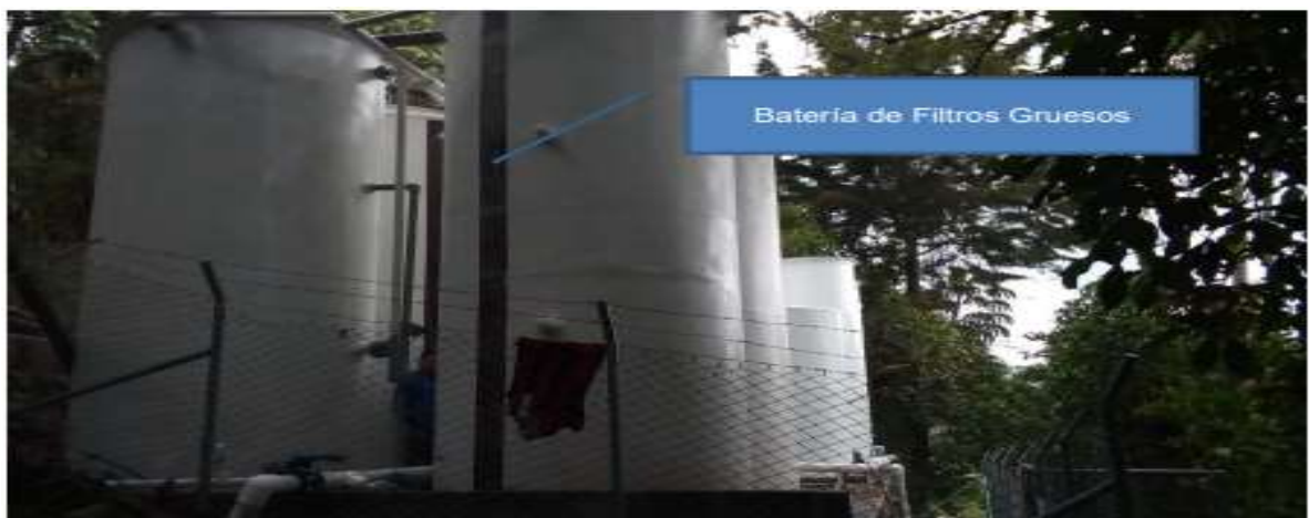
Ilustración 9: Batería de filtros gruesos
