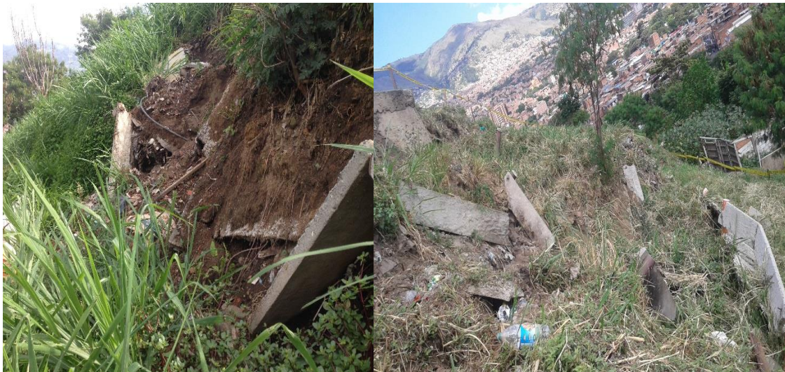
Fig. 24. Desmoronamiento de estructuras
