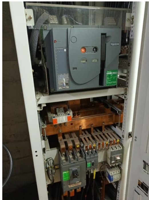
Fig. 6 Gabinete de protecciones
