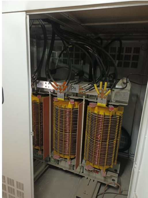
Fig. 3 Celda de Transformadores
