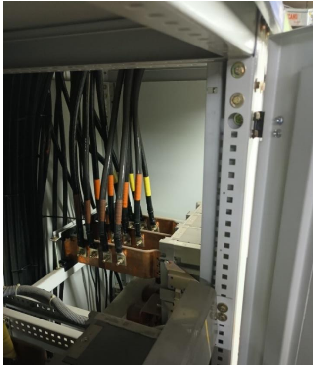
Fig. 21 Barrajes aguas arriba en gabinete de protecciones
