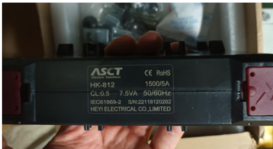
Fig. 10 Placa característica transformador de corriente
