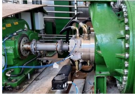
Figura 7. Acople Turbina - Generador.
