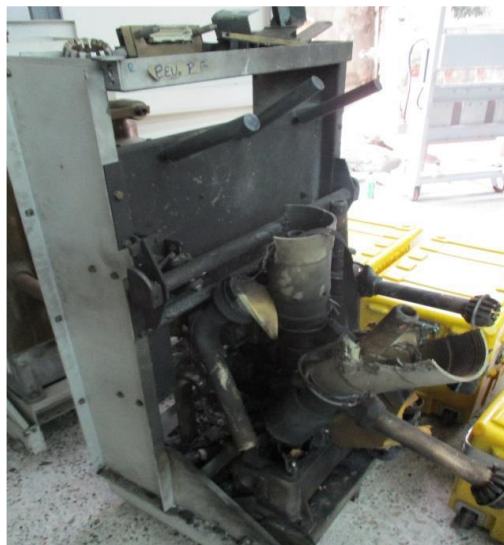
Fig. 6. Explosión de interruptor de potencia de media tensión.
