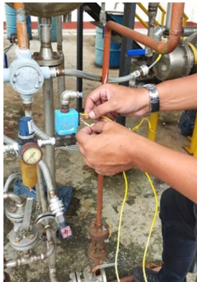
Figura 39 diagnóstico de funcionamiento válvulas solenoides
