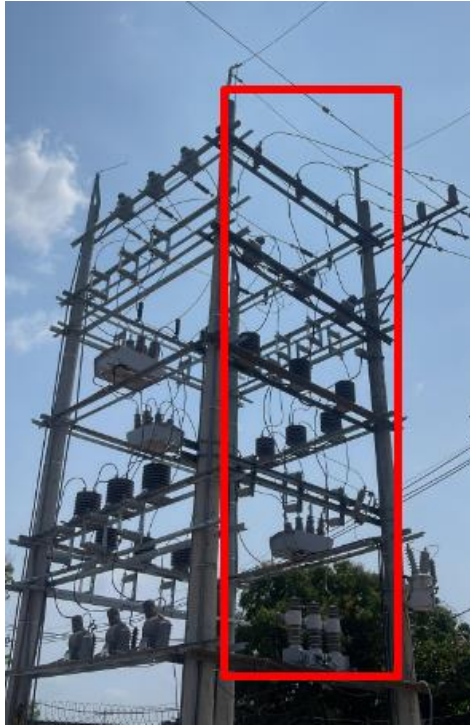
Fig. 8. Bahía Salida Barraje 34.5kV
