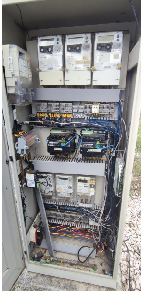
Figura 13. Tablero medidores circuitos y SSAA 13.8kV.
