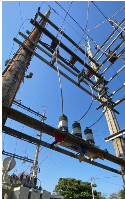
Figura 12. Bahía Llegada Transformador.
