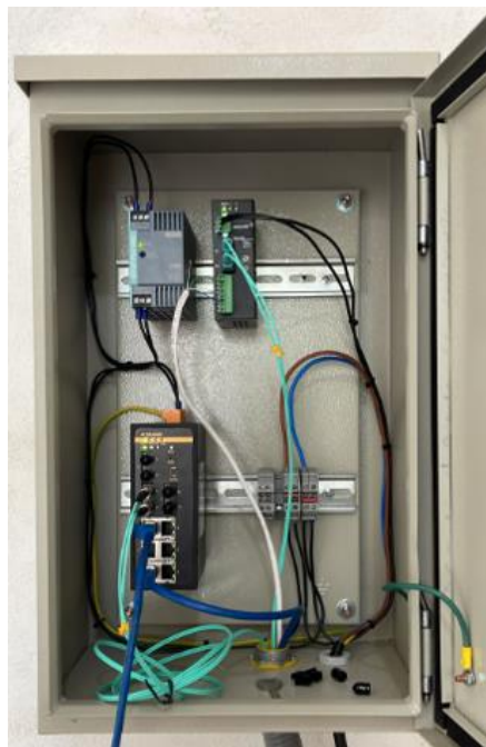
Figura 19. Tablero comunicaciones sala de control
