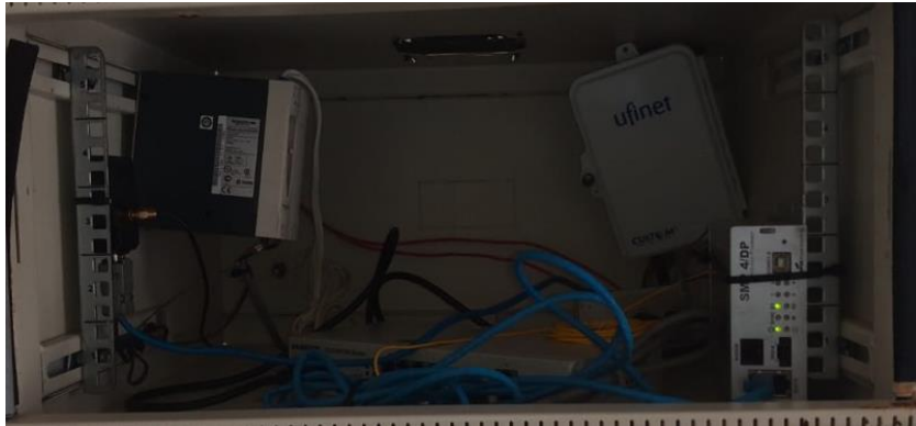
Figura 20. Tablero comunicaciones 2 sala de control
