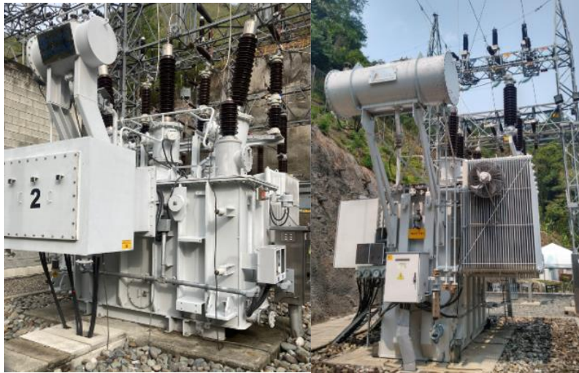
Fig. 28. Transformador de potencia.
