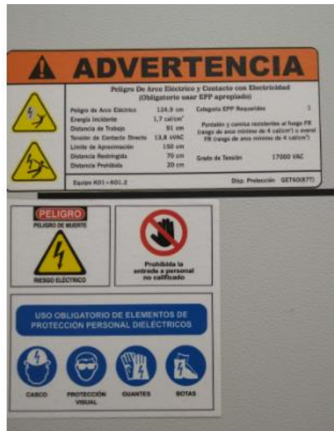
Fig. 22. Etiqueta de riesgo arco eléctrico.
