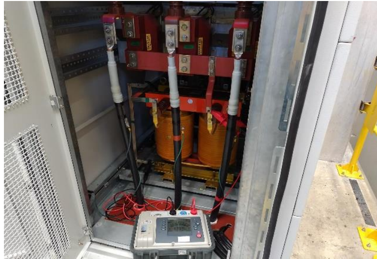
Fig. 9. Transformador de puesta a tierra 1.
