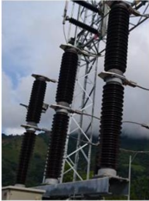
Fig. 15. Interruptor de potencia.
