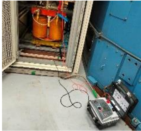
Fig. 10. Prueba en el transformador de puesta a tierra 2.
