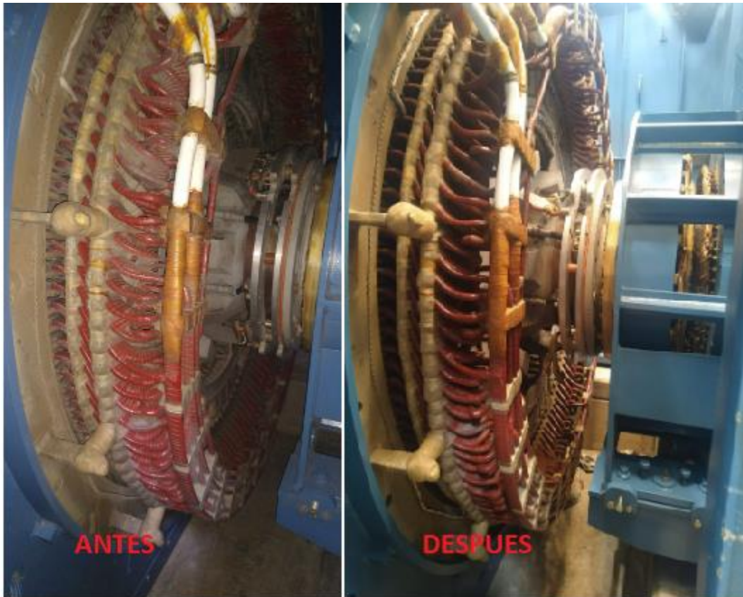
Fig. 12. Comparativa visual de la limpieza del bobinado del generador.
