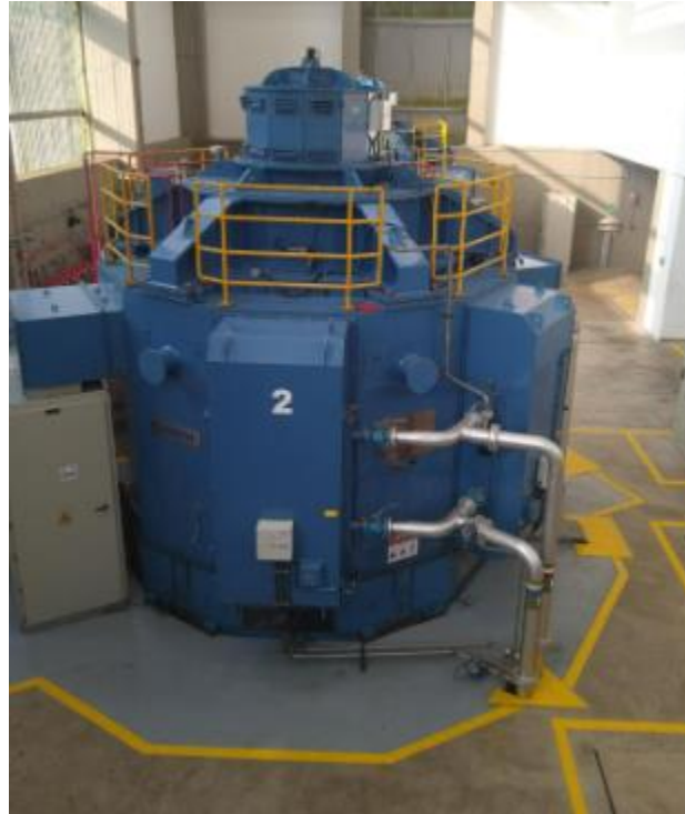
Fig. 1. Generador de CH San Miguel.
