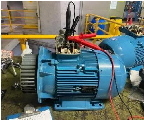
Fig. 14. Pruebas resistencia de aislamiento en motores.
