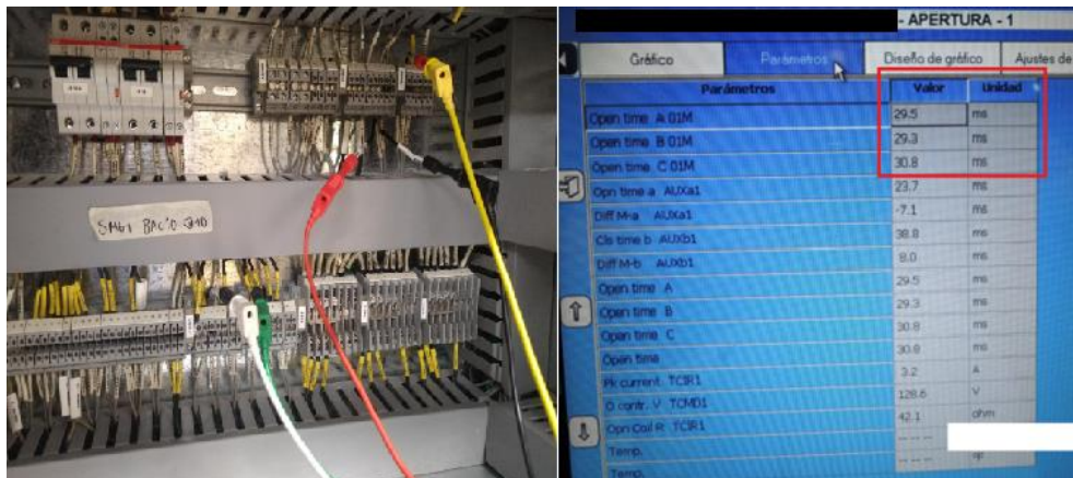
Fig. 27. Prueba tiempos de cierre y apertura en el interruptor de media tensión.
