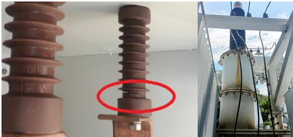
Fig. 29. Fisura en aislador de baja del transformador y fuga de aceite por la empaquetadura de la base del pasatapas de A.T.
