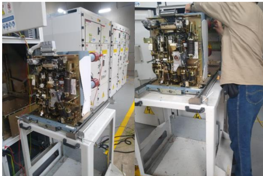
Fig. 23. Interruptor de media tensión.
