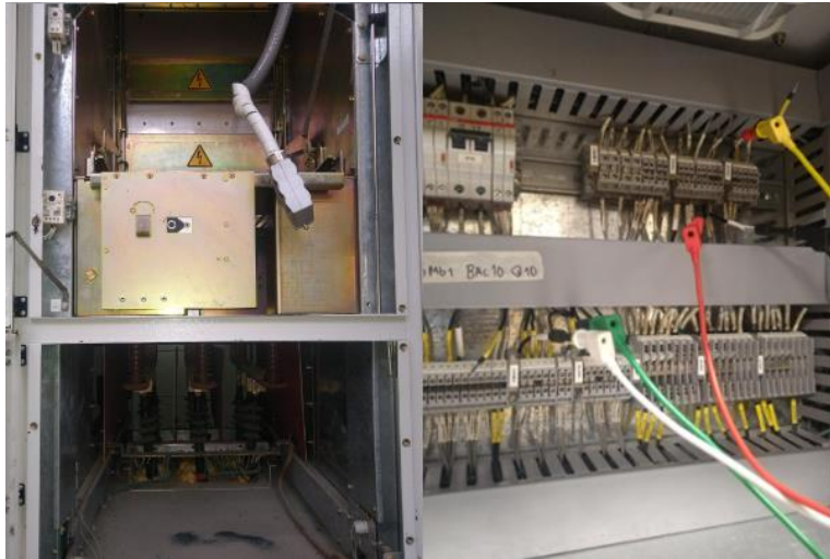
Fig. 24. Celda de media tensión.
