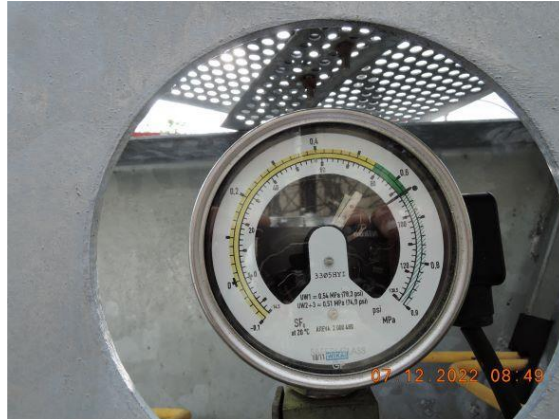
Fig. 19. Presión del gas SF6 del interruptor.
