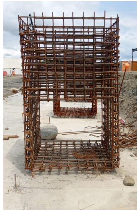
Figura 19. Vista lateral de canasta de acero de caja eléctrica tipo IV.
