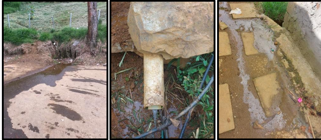
Figura 21. Aguas residuales en el camino.
