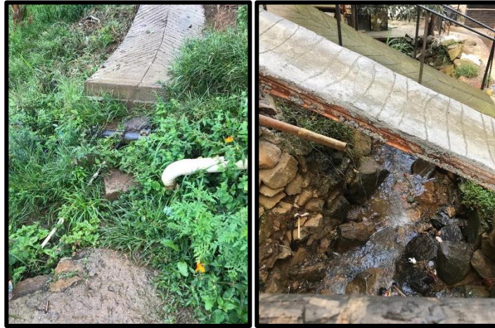
Figura 30. Desagües o tuberías de aguas residuales
