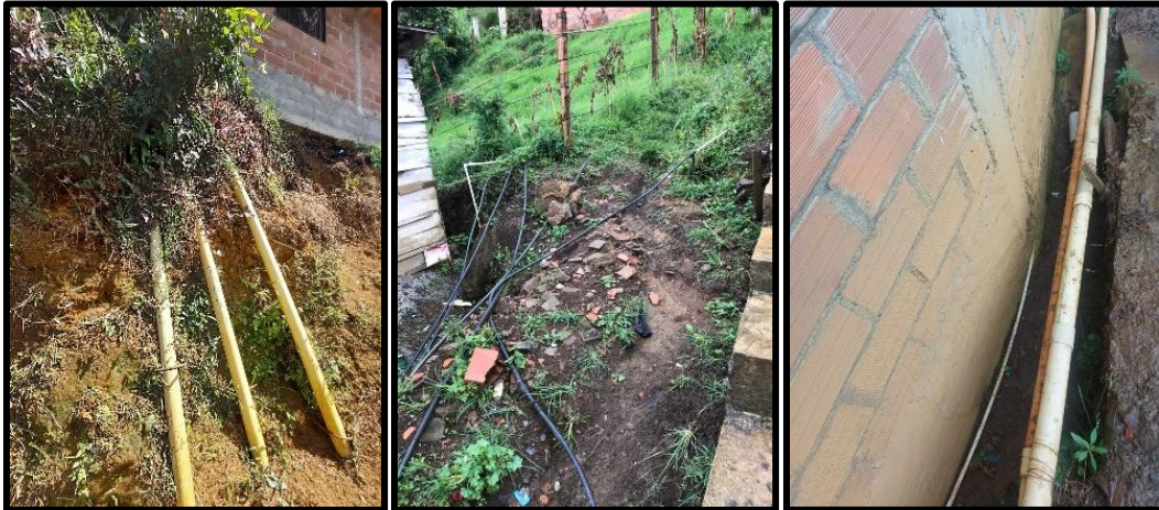
Figura 20. Red de tuberías encontradas en Bello Oriente
