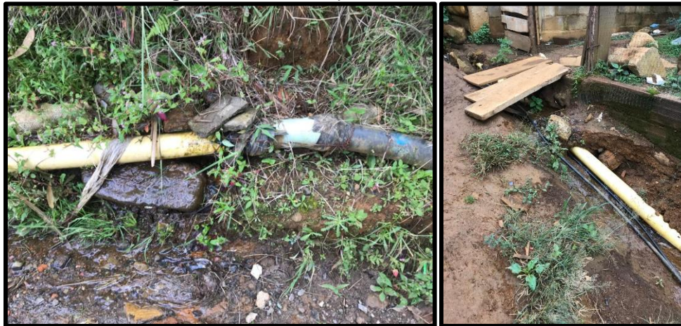
Figura 26. Tubería expuesta a contaminantes
