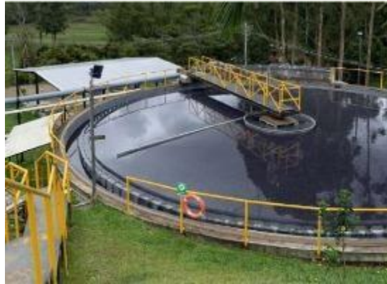
Figura 8. Sedimentador Planta de Tratamiento CRYSTAL S.A.S
