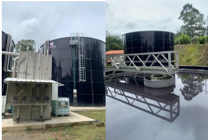
Figura 16. Planta de tratamiento de agua residual TINTATEX S.A
