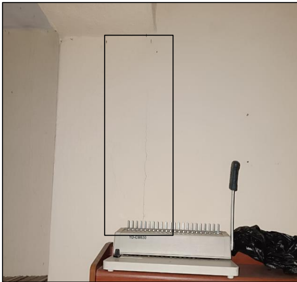
Figura 34. Fisuración en muro 2.
