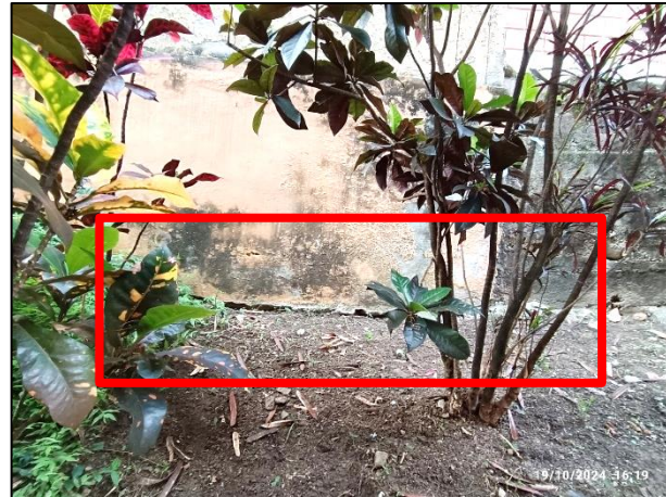
Figura 28. Asentamiento de muro colegio colindante.
