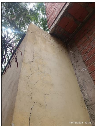
Figura 26. Fisuración en muro colindante a muro 1
