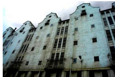
Figura 3. Física – Suciedad (por pintura)
