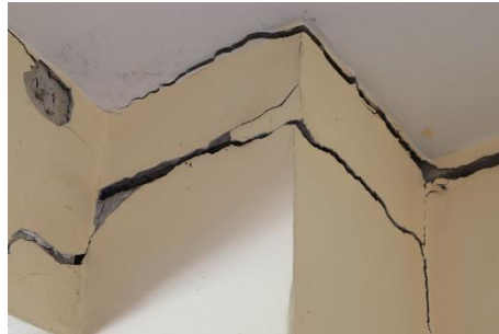
Figura 6. Mecánicas – Grietas Fuente. (Bigstock, 2020)
