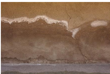
Figura 8. Químicas - Eflorescencia Fuente. (Monto Pinturas, 2017)
