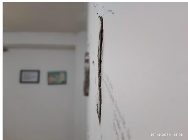
Figura 33. Descascaramiento en muro 1.
