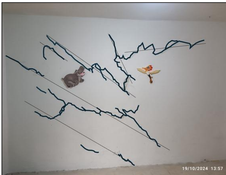
Figura 29. Fisuración y agrietamiento en muro 1
