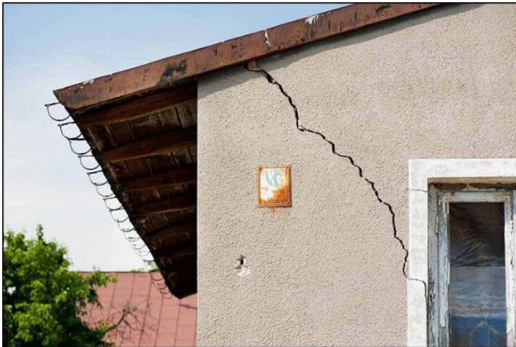
Figura 1. Fisura en fachada
