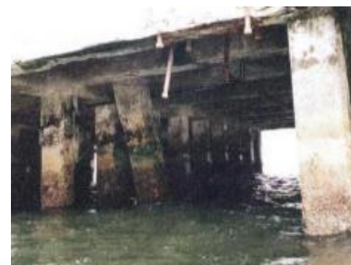
Figura 10. Mecánicas – Desprendimiento Fuente. (Gonzales, n.d.)
