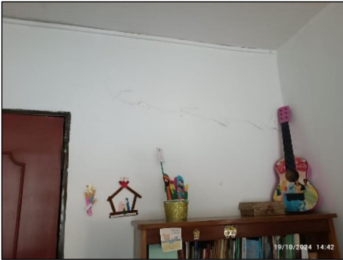
Figura 35. Fisuración en muro 3.
