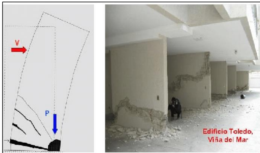
Figura 16. Falla por flexión - Edificio muros edificio Toledo Villa del Mar (Chile 2010)
