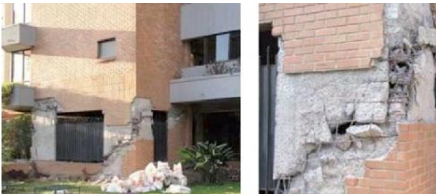
Figura 17. Falla por corte - Edificio en Viña del Mar
