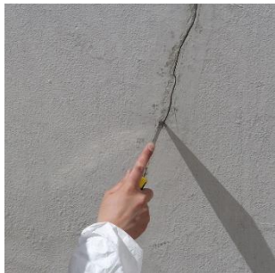
Figura 5. Mecánicas – Fisuras Fuente. (S.A.T / Paredes Exteriores, 2016)
