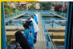
Planta de agua potable Maria Auxiliadora
