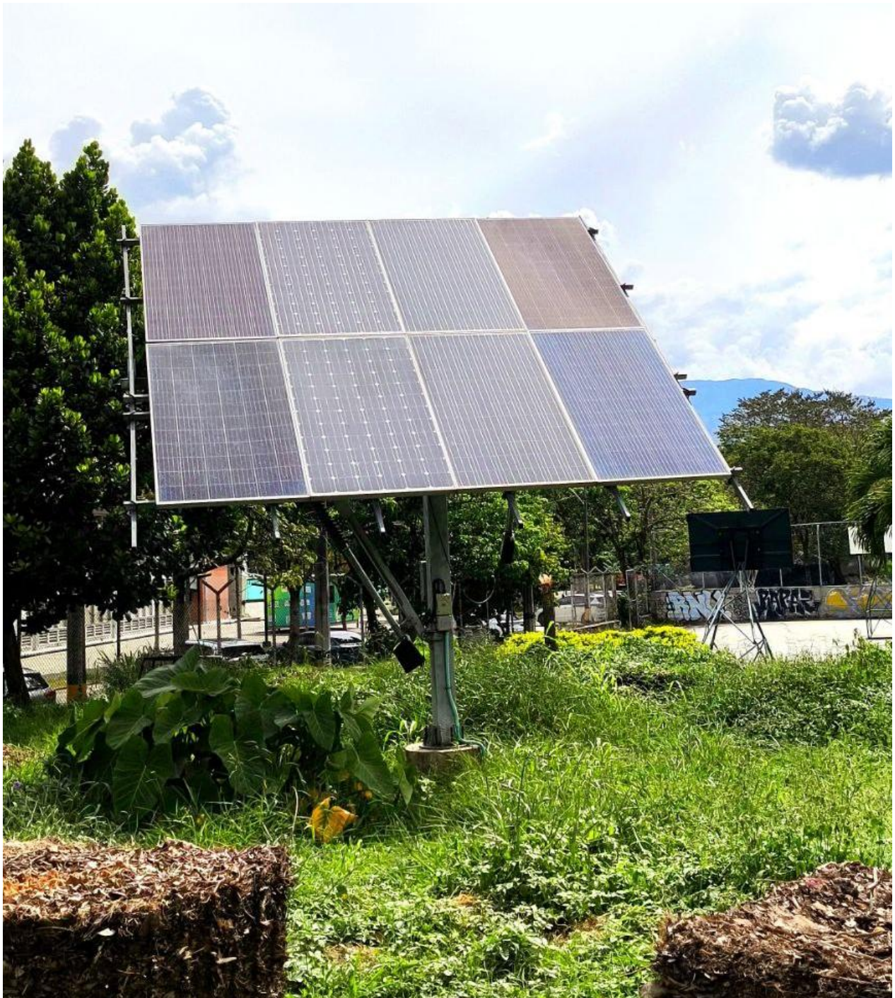
Fig. 7. Paneles solares Seguidor solar a doble eje, DAST
