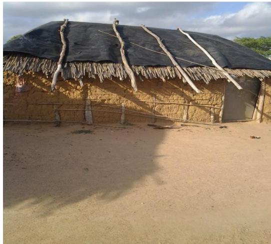
Figura 35. Fotografía casa Wayúu deteriorada
