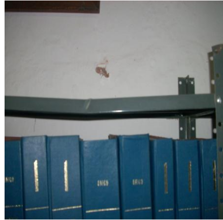
IMAGEN 25: Mal estado de la pared y de estantería.
