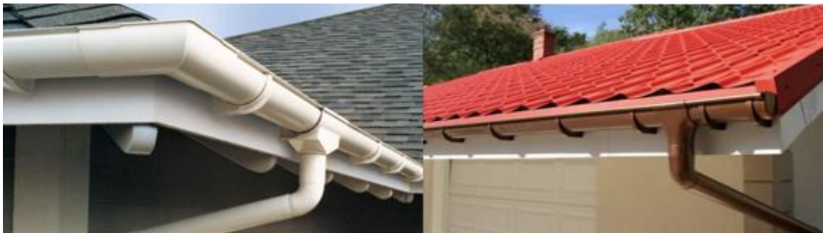
Figura 3. Canales para la colección del agua lluvia captada. Tomado de: (CEPIS, 2003).
