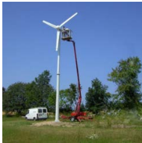
Fig. 35. Equipos de elevación (Front Generator Wind Turbine, 2019)
