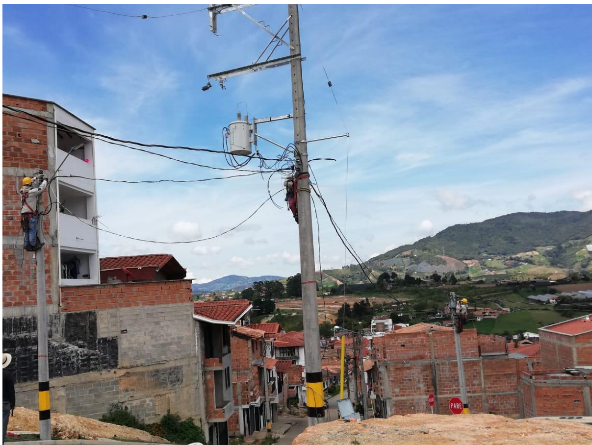
Imagen D. 7. Instalación alumbrado público..
