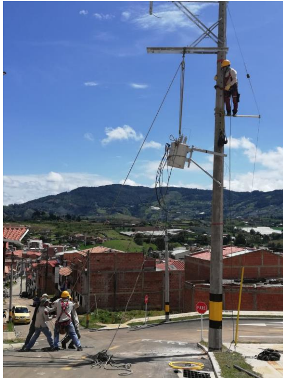
Ilustración 1. Instalación de Transformador de 75 kVA en TUTO.
