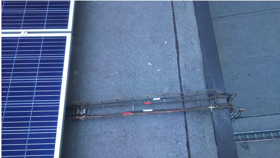
Fig. 22. Cables y canalización.
