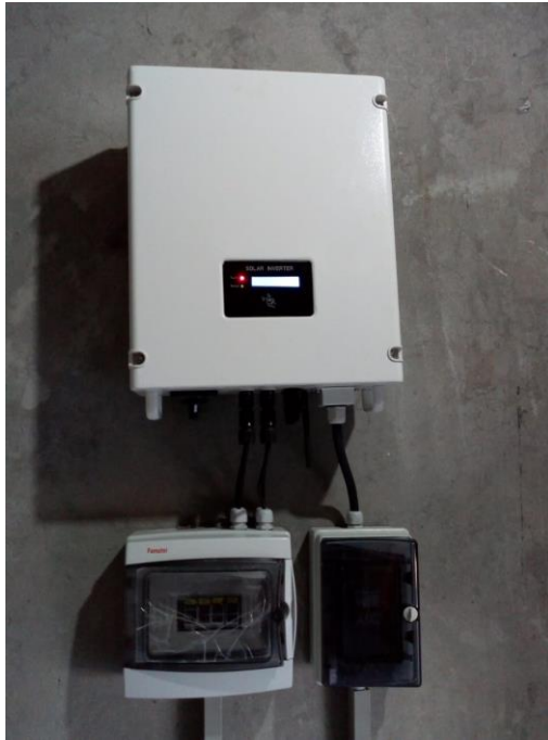
Fig. 23. Inversor y cajas de protecciones para DC y AC.
