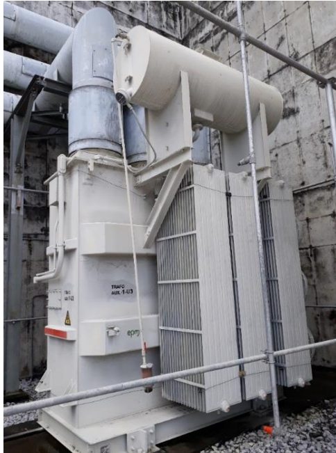
Figura 20. Transformador auxiliar unidad 3-1, 12.5 MVA.
