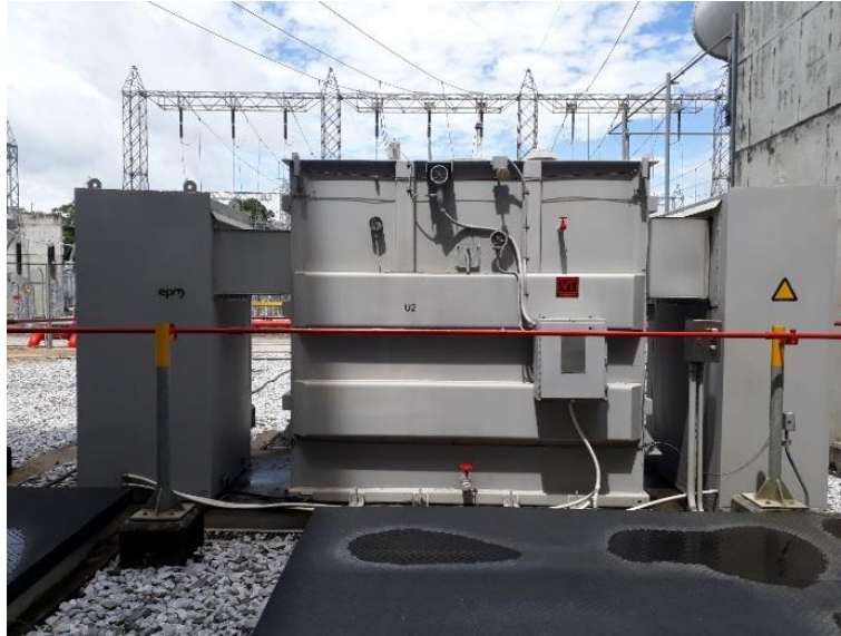
Figura 26. Transformador de aislamiento unidad 2, 5 MVA.
