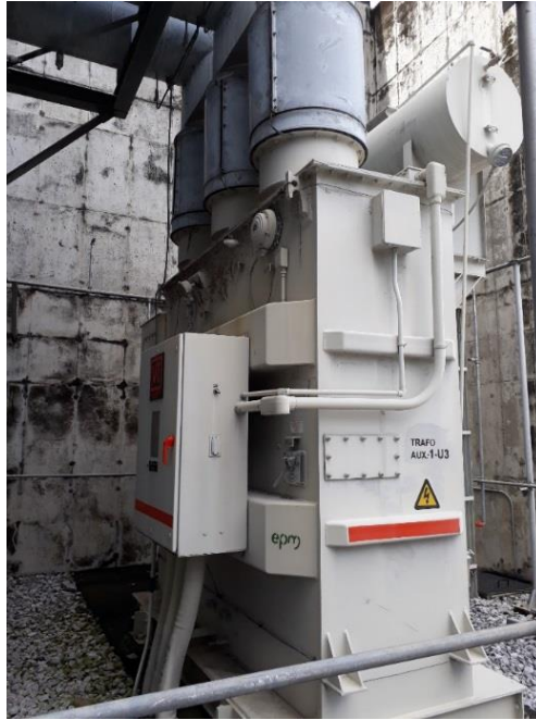
Figura 22. Transformador auxiliar unidad 3-2, 12.5 MVA.
