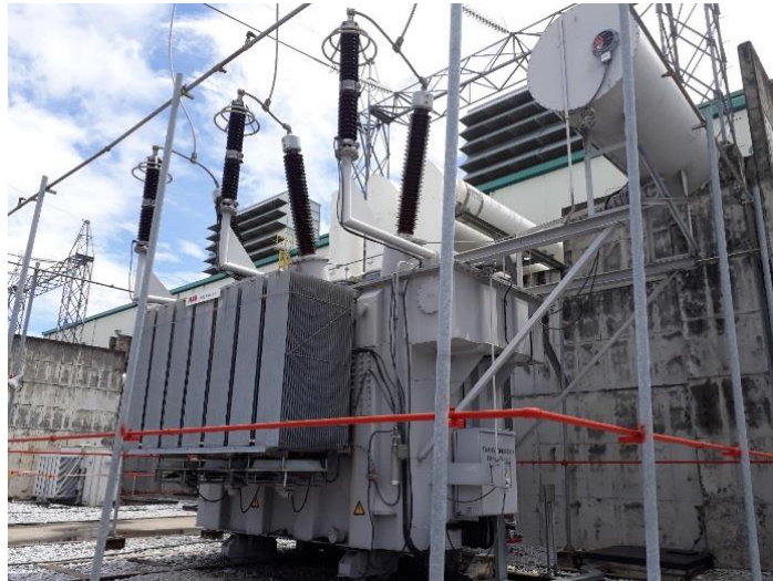
Figura 12. Transformador principal unidad 2, 185 MVA.
