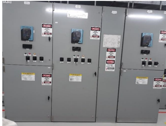
Figura 51. CCM Intake, Celdas de 4160V.
