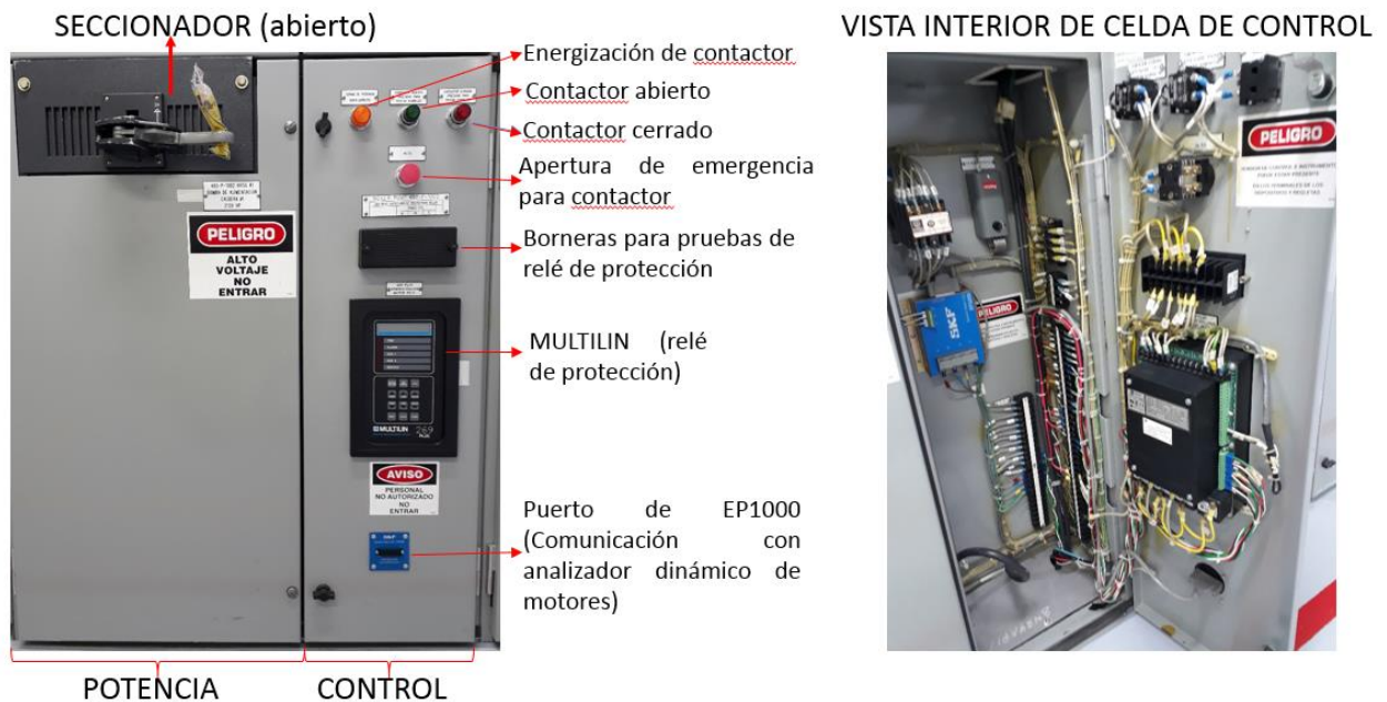
Figura 62. Celdas de control CCM Ciclo Combinado para bombas FEED WATER y de circulación.
