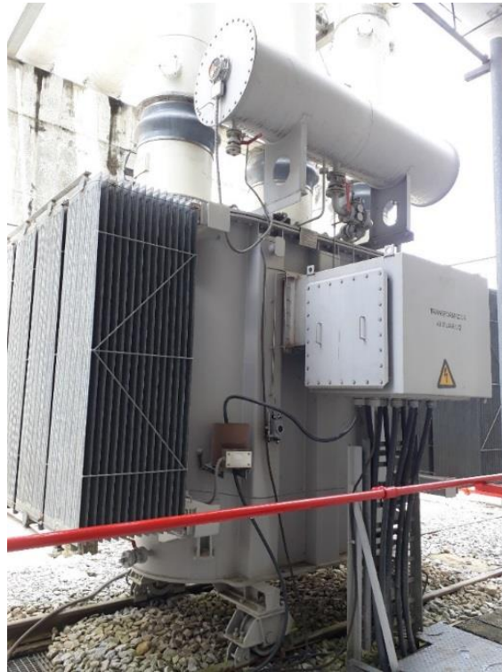
Figura 18. Transformador auxiliar unidad 2, 12.5 MVA.
