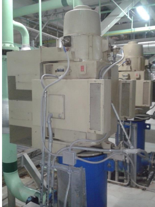
Figura 38. Motores de condensado.
