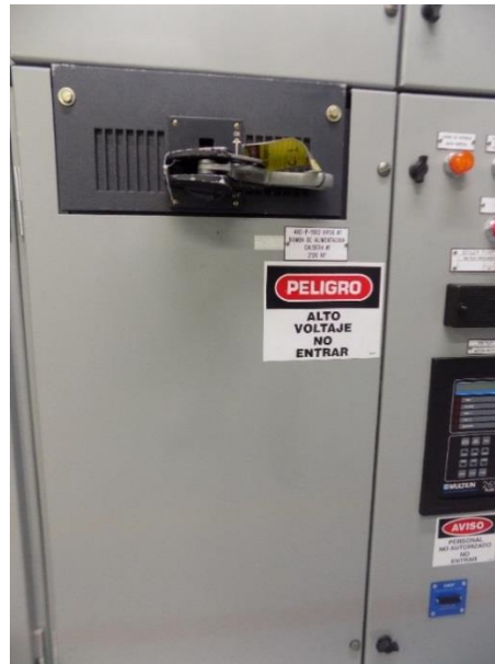
Figura 44. Celda de media tensión.
