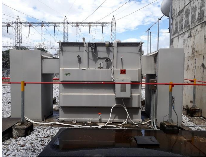
Figura 24. Transformador aislamiento unidad 1, 5 MVA.
