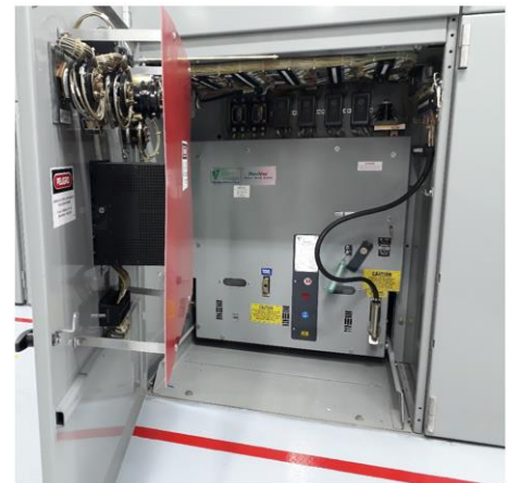
VISTA INTERIOR DE CELDA DE CONTROL
