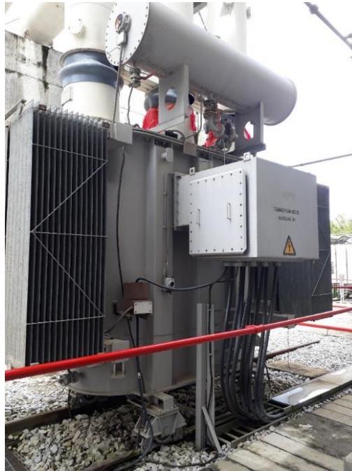
Figura 16. Transformador auxiliar unidad 1, 12.5 MVA.
