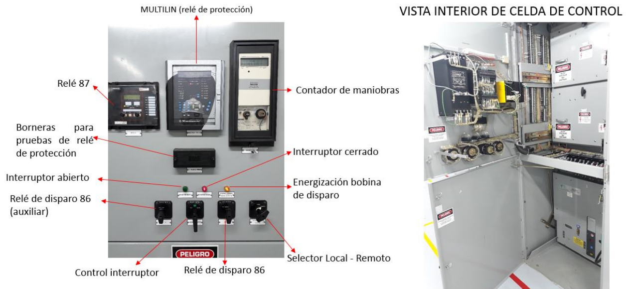
Figura 57. Celdas de control CCM Ciclo Combinado para interruptores de acometida (5211 y 5212).
