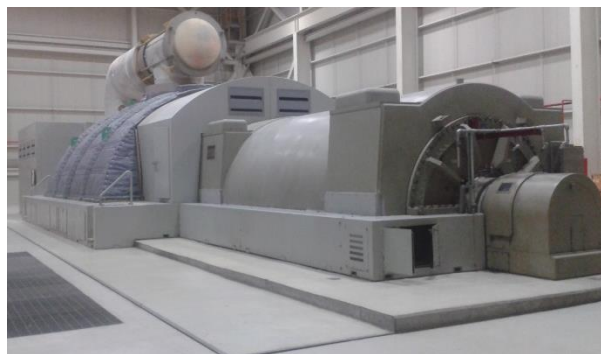
Figura 8. Generador de unidad 3.
