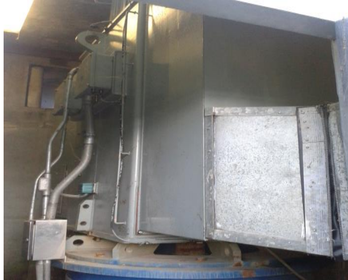
Figura 40. Motor de bomba de circulación.
