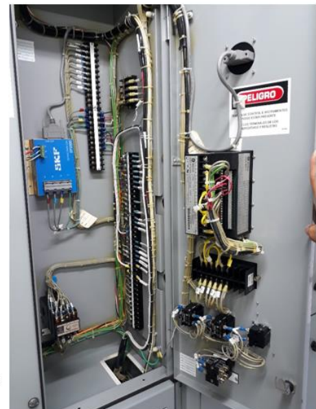
VISTA INTERIOR DE CELDA DE CONTROL
