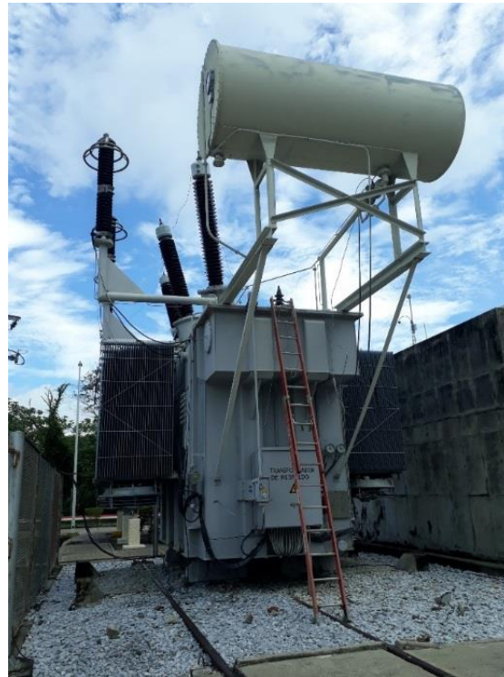
Figura 28. Transformador de reserva, 185 MVA.
