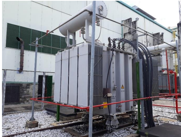
Figura 30. Transformador de respaldo, 12.5 MVA.
