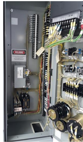
VISTA INTERIOR DE CELDA DE CONTROL
