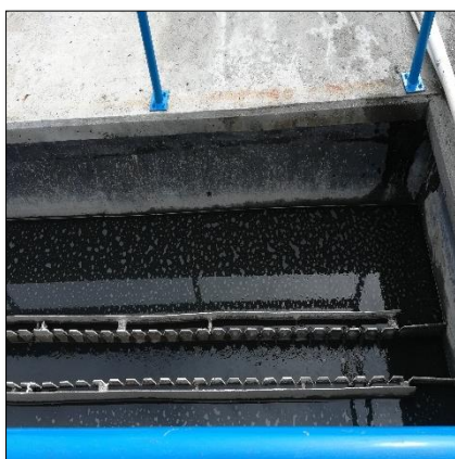
Foto 33. Cámara 1 reactor UASB PTAR Sonsón Tomada por: María Camila Gómez
