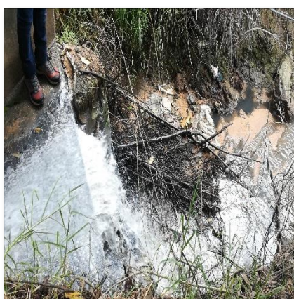
Foto 36. Estructura de descarga a la fuente receptora PTAR Sonsón Tomada por: María Camila Gómez
