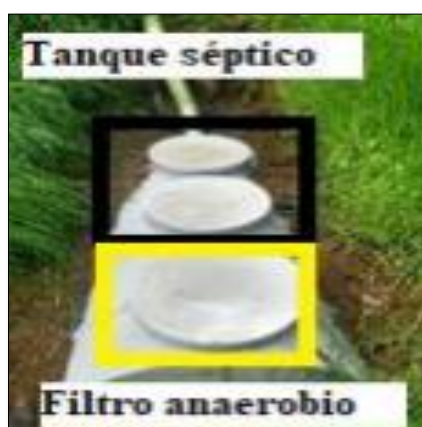
Foto 32. Tanque séptico y filtro anaerobio Tomada por: Santiago Londoño
