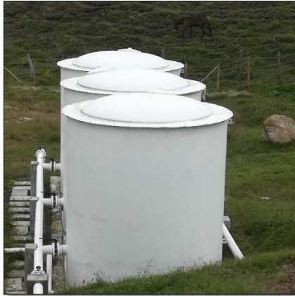
Foto 19. Filtros anaerobios de flujo ascendente (FAFA) Tomada por: María Camila Gómez
