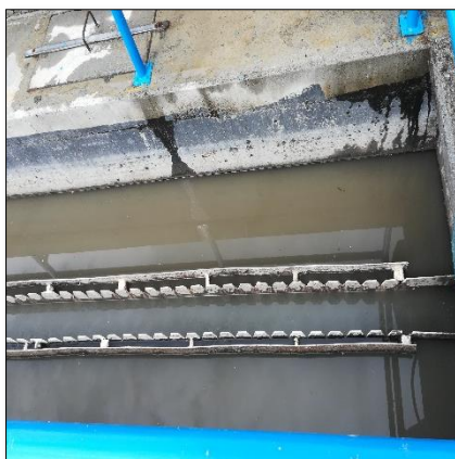
Foto 34. Cámara 2 reactor UASB PTAR Sonsón Tomada por: María Camila Gómez
