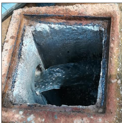
Foto 35. Estructura de salida filtros anaerobios PTAR Sonsón Tomada por: María Camila Gómez
