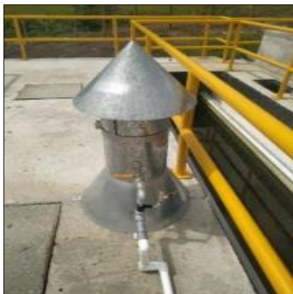
Foto 18. Quemador de biogás Tomada por: Lizeth Mesa
