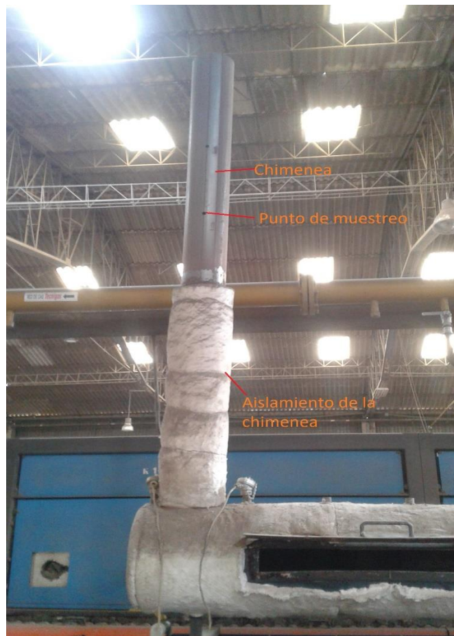
Figura 12. Chimenea de banco de pruebas para quemadores industriales a gas natural (realización propia).
