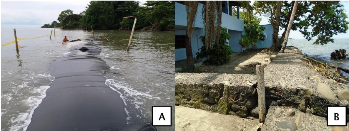
Figura 7. Obras estructurales del municipio de Turbo. A) Geotubo. B) Muro de contención
