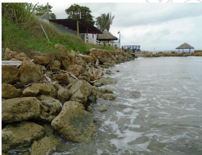
Figura 13. Enrocado en el municipio de Arboletes
