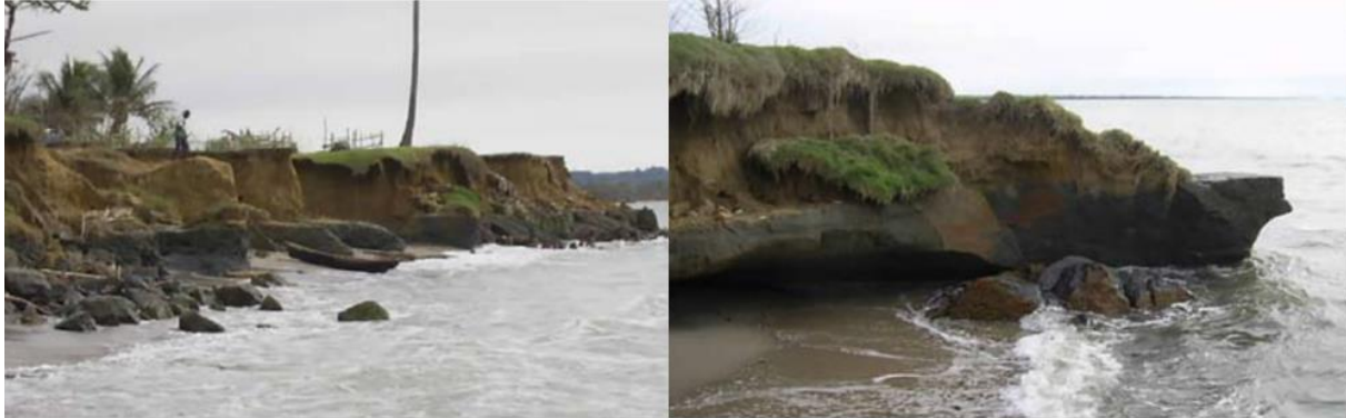
Figura 1. Erosión por escorrentía y socavación en la base de taludes sobre rocas no cohesivas en el sector costero de Zapata, Antioquia (Colombia). Fuente: (Posada & Henao., 2008)
