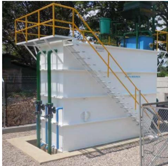
Imagen 8: Planta de tratamiento Acuatecnica
