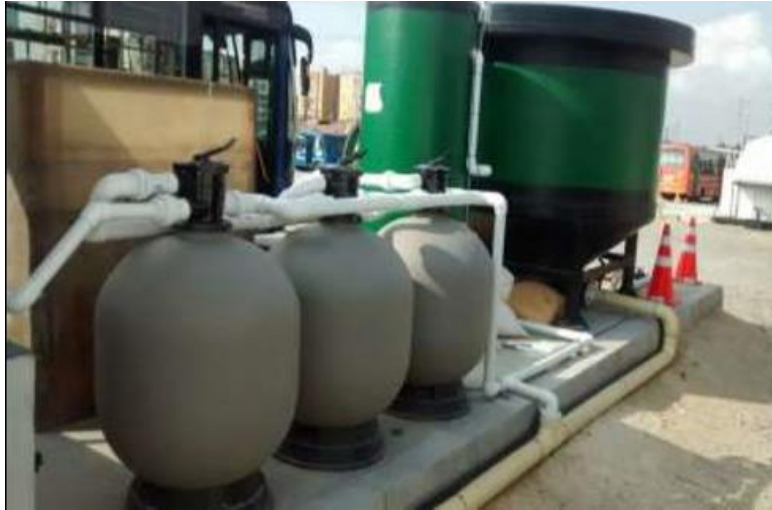
Imagen 7: Planta de tratamiento ASI
