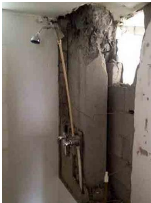
Figura 7 Falla de la columna S3 en el nivel 4 vista desde el interior del apartamento. Tomada de: https://www.facebook.com/ElColombiano/posts/529830203773690/
