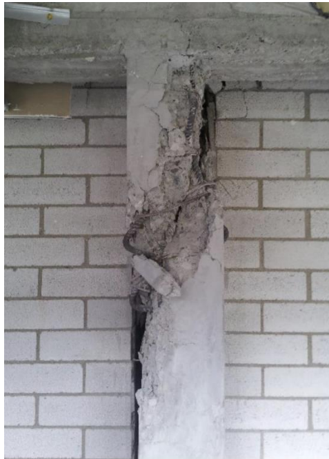
Figura 6 Falla en columna S3 al nivel 4, vista desde el pasillo. Tomada de: https://www.facebook.com/ElColombiano/posts/529830203773690/
