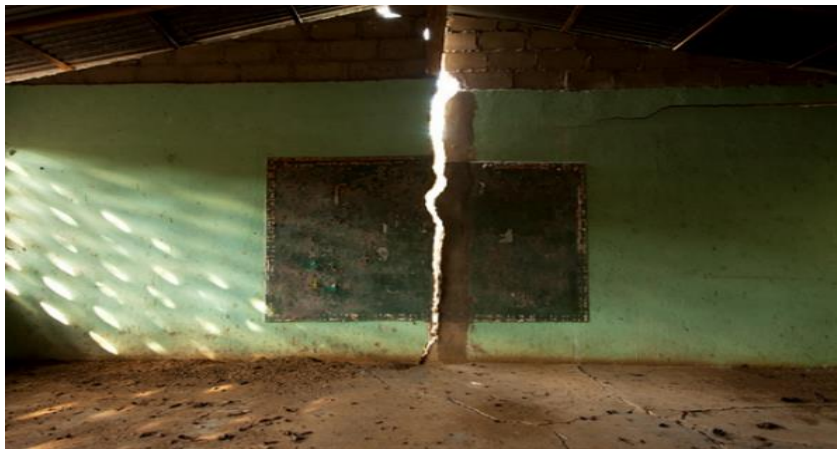
Figura 22. Silencio con grieta. Fotografía. (Juan Manuel Echavarría, 2011).
