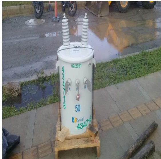
Figura 11 Transformador con serie asignada por el operador de red
